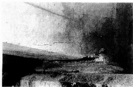
写真-3.10 支承部斜めひび割れ
