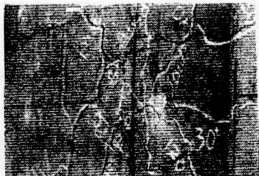
写真-3.12 床版支間中央のひび割れ
