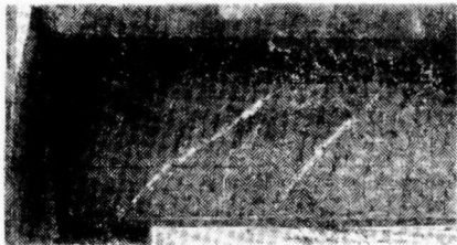
写真-3.6 端部斜めひび割れ
