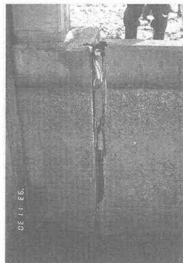
写真 9.5.2 ピアア柱（左側）と護岸壁（右側）とのずれ [丸山第4頭首工]
