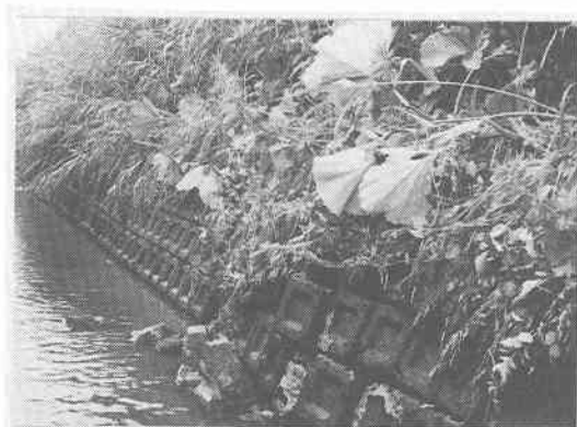
写真 9.3.1 積みブロック水路の被災状況
