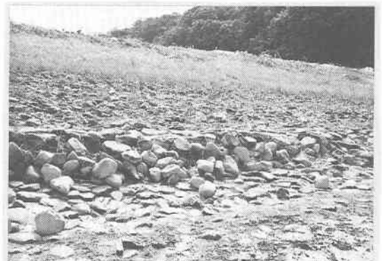
写真9.2.2 丹羽生嶺ダム左岸上流斜面のふくらみ
