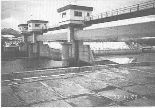
写真 9.5.7 当路頭首工全景と右岸高水敷部の沈下
