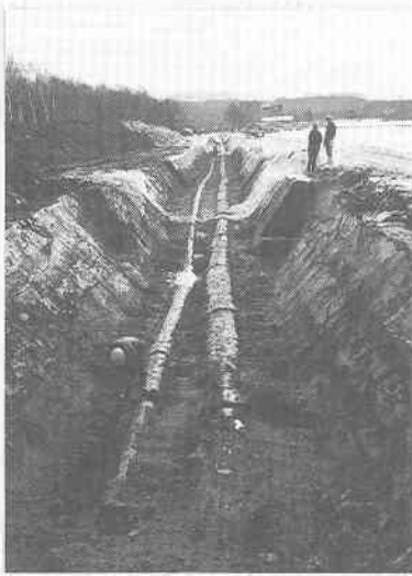
写真 9.4.4 2連の併設パイプラインの変状
