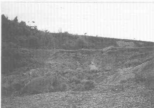
写真 9.6.1 農地造成地の法面崩壊（知内地区）
