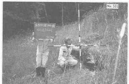
写真9.4.1 斜面部に生じたクラック
