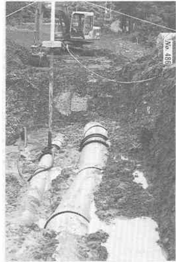
写真 9.4.5 液状化によるパイプラインの変状
