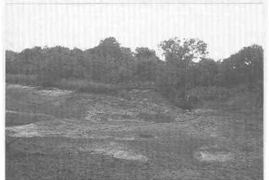
写真 9.2.4 柳田沢ため池の決壊箇所
