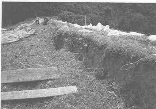
写真9.2.1 丹羽生嶺ダム天端の段差
