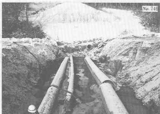
写真 9.4.9 3 連の併設パイプラインの変状
