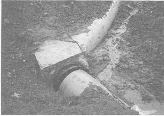
写真 9.4.2 スラストブロックの移動
