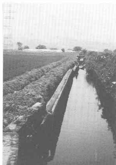
写真 9.3.2 L形ブロック水路の被災状況
