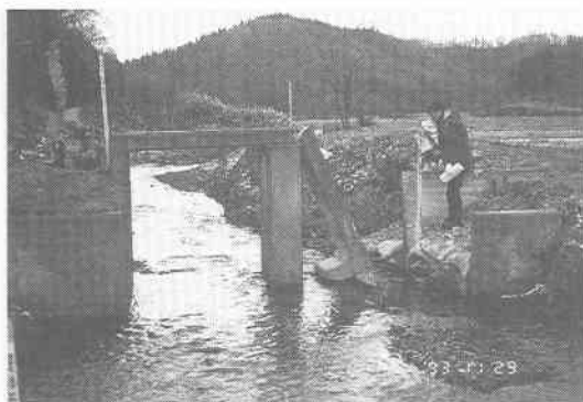
写真 9.5.1 左岸側ピアアの倒壊 [鍼川第4頭首工]
