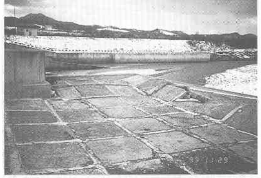
写真 9.5.8 右岸下流側高水敷部張ブロックの沈下 [当路頭首工]
