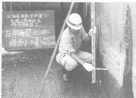
写真 9.5.4 右岸擁壁の傾斜 [丹羽頭首工] (北海道開発局提供)
