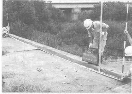
写真 9.5.6 左岸高水敷部の沈下 [丹羽頭首工] (北海道開発局提供)
