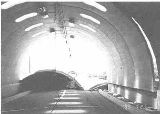
写真7.1.10 崩壊したシェルター
