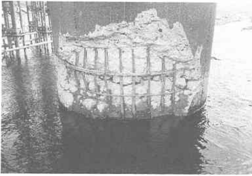
写真 7.2.25 主鉄筋が座屈するとともに、コンクリートが完全に破壊した P3 橋脚 (新知内橋, 下流側から)
