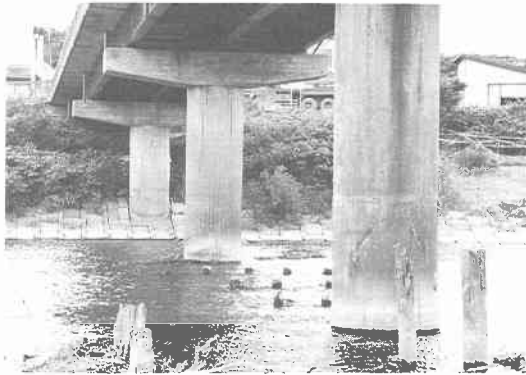
写真 7.2.13 基栄橋 P2, P3 橋脚の損傷
