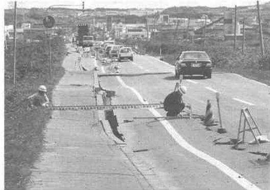
写真 7.1.7 国道 229 号江差町柳崎における盛土被害 (北海道開発局函館開発建設部による)
