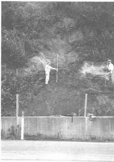
写真7.3.1 道道1170号線沿いの崩壊(その1)
