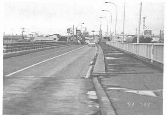
写真 7.2.21 長万部橋の橋脚傾斜に伴う路面の曲がり (A2 橋台側より)
