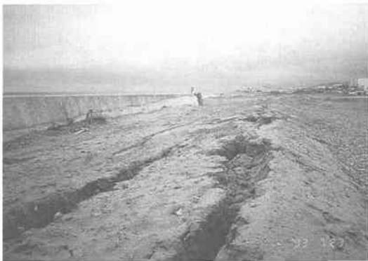
写真 7.1.6 工事中の国道 5 号長万部バイパスの盛土被害
