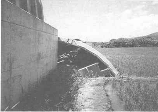
写真 7.1.12 下部工 (堅壁の転倒)
