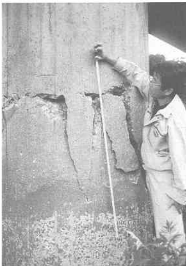
写真 7.2.23 元瓜谷橋の橋脚の損傷
