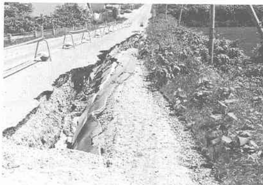
写真 7.1.8 道道奥尻町線米岡の盛土崩壊
