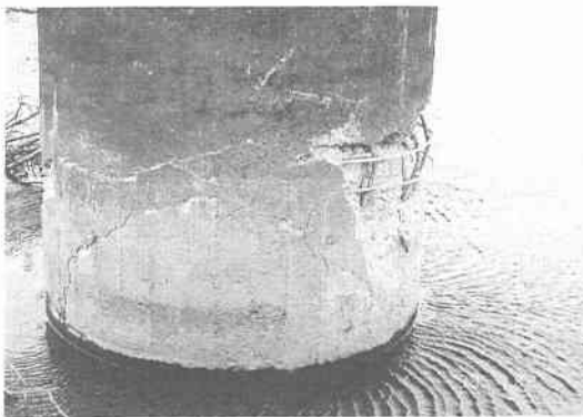
写真 7.2.11 基栄橋のコンクリート剥離および鉄筋の露出 (P4 橋脚, 下流側)
