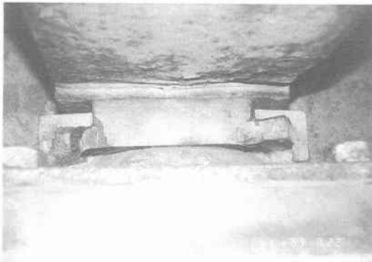
写真 7.2.17 柳崎橋橋台支承部のストッパーの座屈および破断
