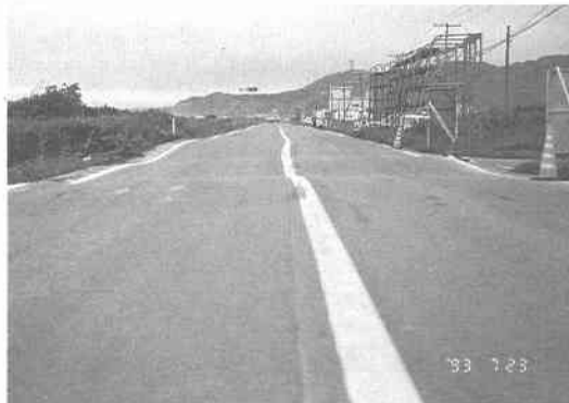
写真 7.1.5 国道 5 号長万部町豊津の液状化による道路の波打ち
