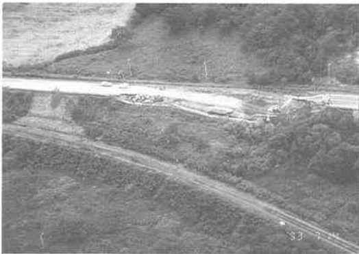
写真7.1.1 国道5号長万部町知来の盛土崩壊(航空写真)
