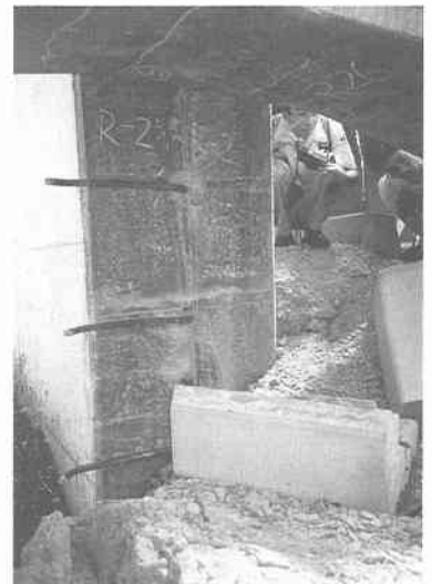
写真7.1.11 破断したアンカー
