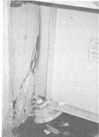
写真 7.2.2 上磯新橋腹板の損傷 (A2橋台)
