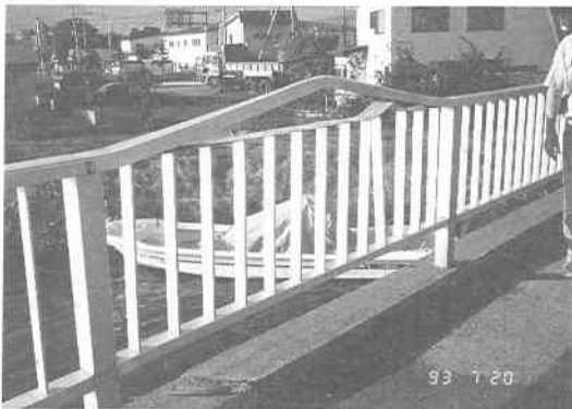
写真 7.2.4 上磯新橋高欄の座屈
