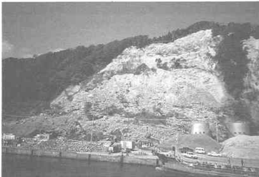
写真 7.3.3 道道奥尻 - 青苗線沿いの崩壊
