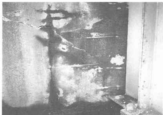
写真 7.2.8 新有川橋 A2 橋台パラペットのひびわれ
