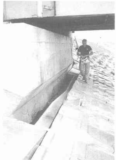
写真 7.2.18 柳崎橋橋台の護岸の移動（橋台前面）
