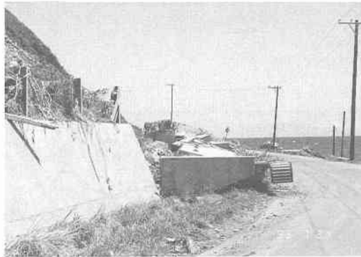
写真 7.1.14 重力式擁壁の転倒状況
