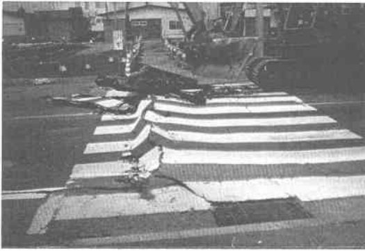
写真 7.1.3 国道 228 号函館市東浜町のアスファルト舗装の盛り上がり（北海道開発局函館開発建設部による）
