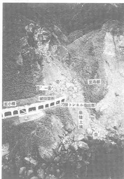
写真 7.3.6 地震直後の崩壊斜面全景 (1993.7)
