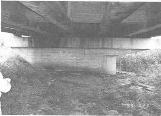
写真 7.2.20 長万部橋 P2 橋脚の傾斜 (写真左方に 1°59'30"傾斜)
