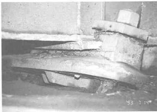
写真 7.2.7 新有川橋 A2 橋台杓座モルタルの破壊
