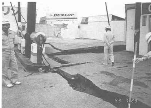
写真 7.1.15 ガソリンスタンドの被害状況
