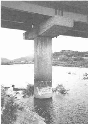
写真 7.2.10 基栄橋 P4 橋脚の損傷（下流側から）
