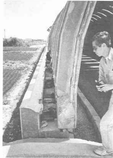
写真 7.1.13 堅壁の水平方向への変位
