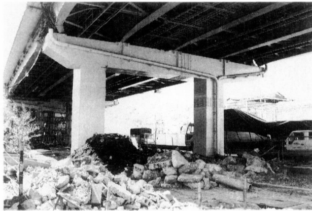
写真1-5 鋼製ラーメン橋脚の隅各部のクラック
