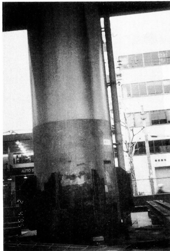
写真1-11 橋脚基部の橋軸直角方向の片側の大きな曲部座屈
