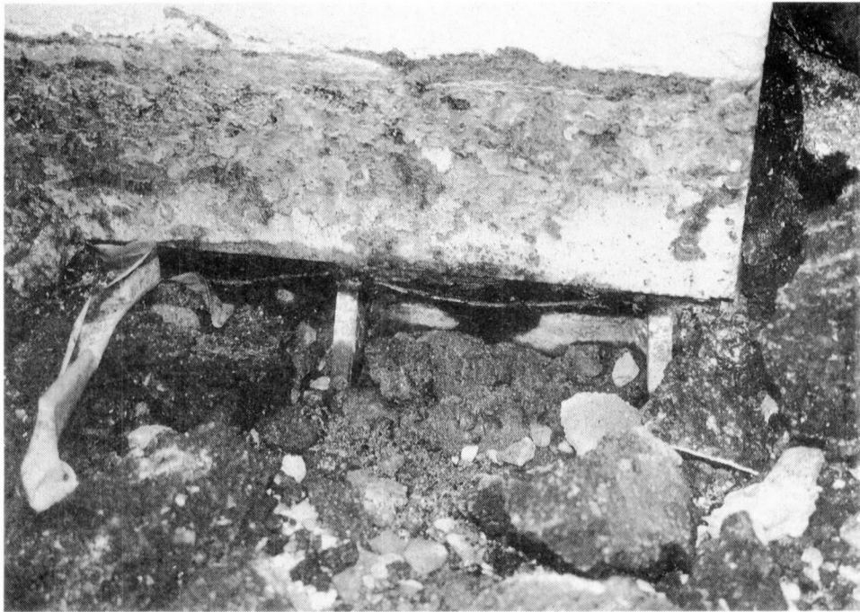
写真 1 - 1 2 ベースプレートと橋脚柱の接合部のクラック
