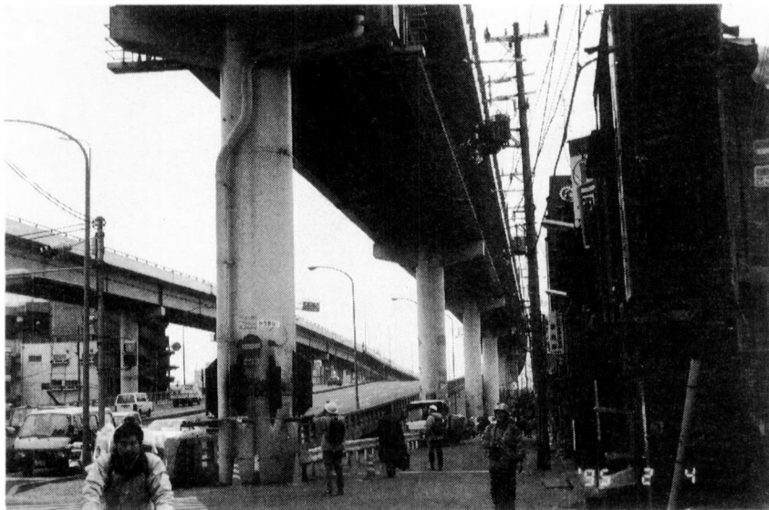
写真1-8 背の高い円形断面T型鋼製橋脚の被害
