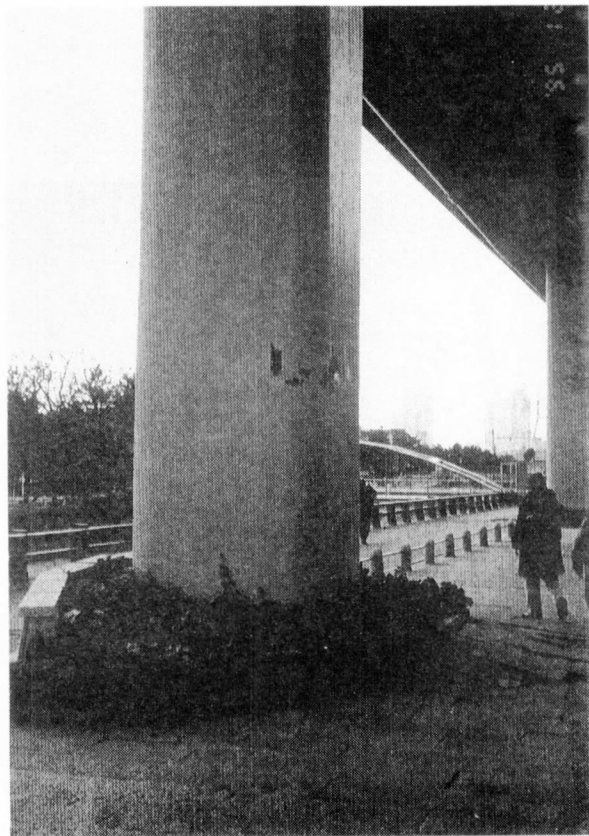
写真 1 - 1 3 コーナー部に曲率をもつ鋼製橋脚の座屈
