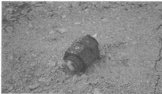
西宮港大橋の落下したアプローチ桁，耐震連結板のピン (落下した側と反対側の耐震連結装置) : 名工大 1/18
