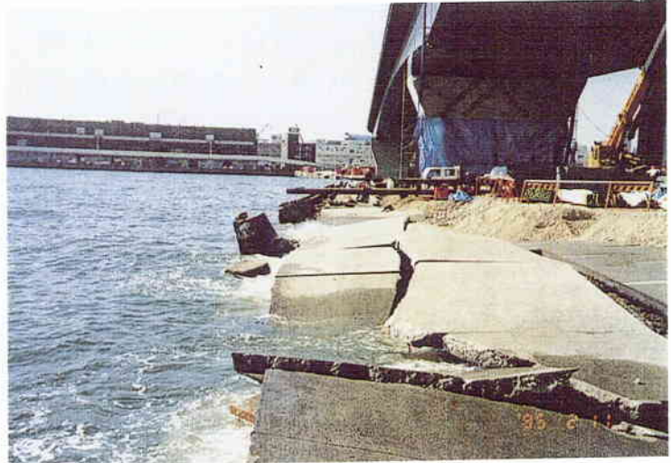
写真－１３ 突堤の護岸の崩壊
