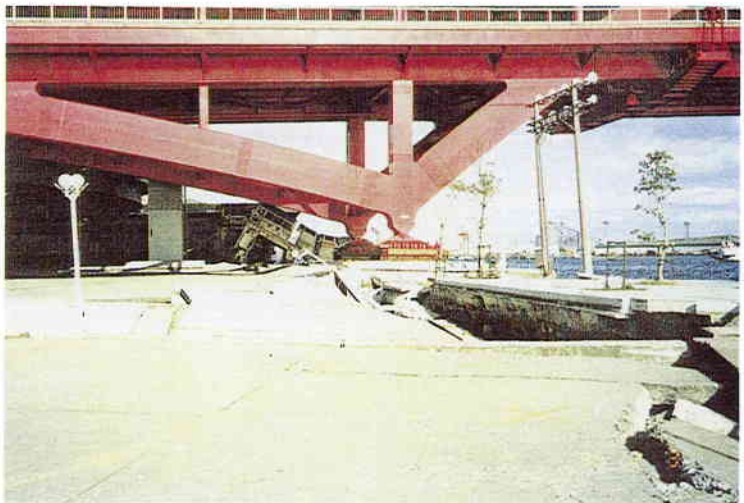
写真－10 神戸大橋（神戸側）橋台背面地盤の変状
