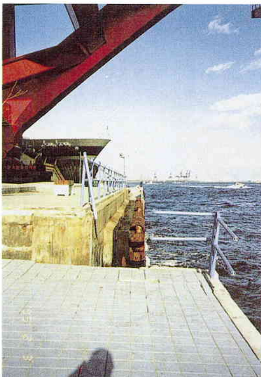
写真－9 突堤突端の護岸の変状
