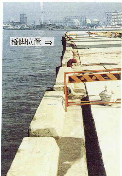
写真－3 周辺護岸の変状
