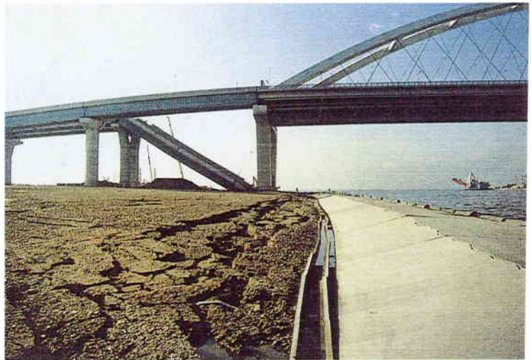
写真－2 橋脚の前面の護岸の状況
