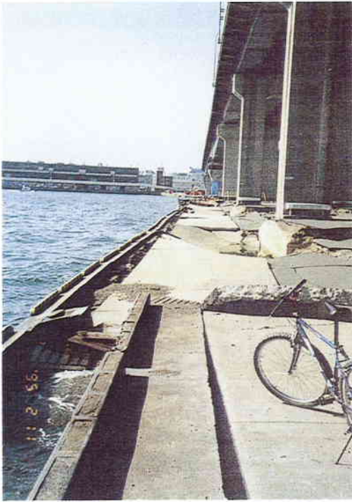
写真－１２ 突堤の南側護岸の崩壊
