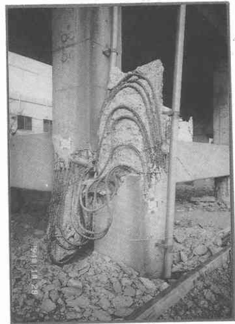
ラーメン橋脚のせん断破壊
