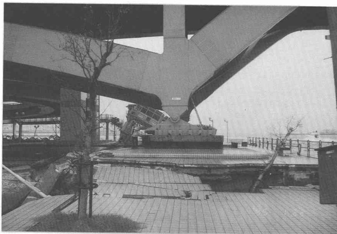
図3 地盤の沈下による場所打ち杭の突出
