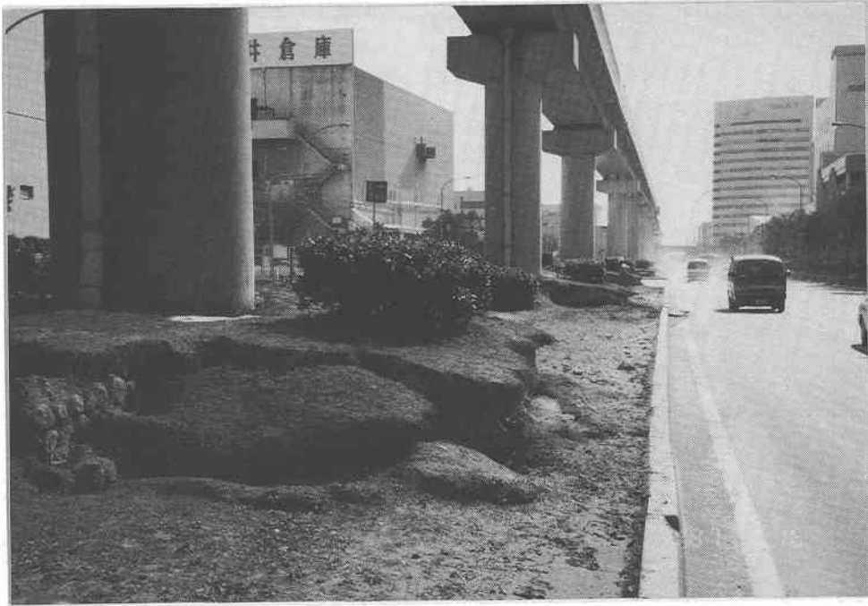
図4 新交通支柱基礎周辺の地盤沈下
