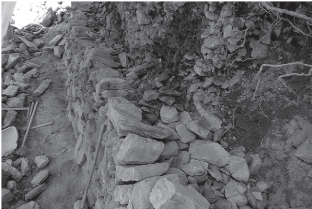
写真3 4日間で、一定区間の石積みを修復する。写真は一度崩した区間の石積みを積みなおしている途中の様子。前面の積み石の裏には「ぐり石」という小さな石を入れる
