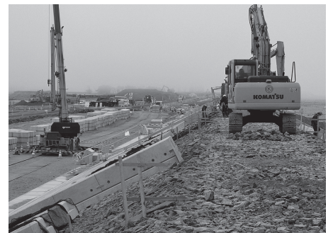
写真2 復興事業で活躍する建設業(仙台湾南部海岸堤防)(提供:宮城県建設業協会)
