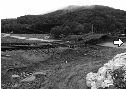
河岸浸食による JR 鉄橋の被災 (新得町・パンケシントク川 2016/9/6)
