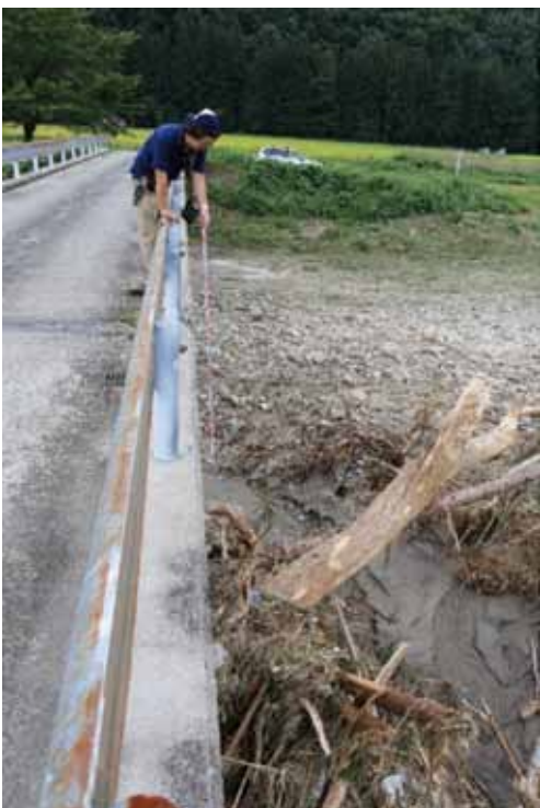
写真3 橋脚の流木 (松沢川) (提供: 川越清樹)
