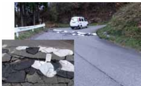
写真10 小川村瀬戸川 路面の段差 (撮影：千代 田コンサルタント 山浦直人氏) →図1⑩
