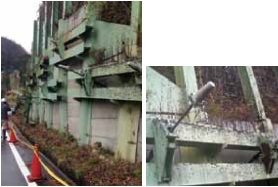
写真2 小谷村土谷川右岸 アンカーロッドの破断・引抜け →図1②
