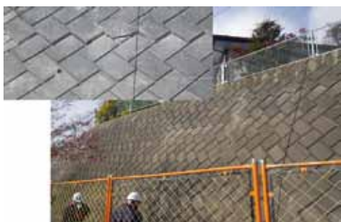
写真19 長野市若槻 蚊里田配水池事務所擁壁の亀裂 (長さ16m程度) →図1⑲
