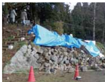
写真14 長野市芋井小中学校 石垣の崩壊→図1⑭
