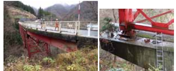
写真3 小谷村土谷川 奉納大橋支承の変状→図1③
