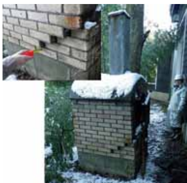
写真12 長野市中条 音楽堂裏の焼却炉のせん断破壊→図1⑫
