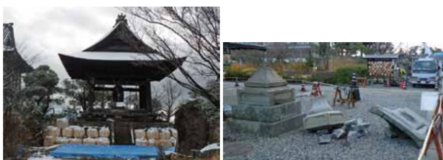
写真18 長野市善光寺 鐘楼基礎の崩壊と石灯籠の倒壊→図1⑱
