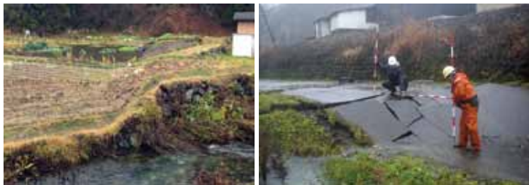
写真6 白馬村塩島 神城断層直上付近の地表面変状 (1m程度の段差) →図1⑥
