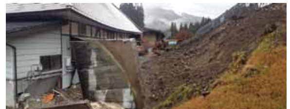
写真7 白馬村堀之内 擁壁の転倒と裏込め土の崩壊→図1⑦
