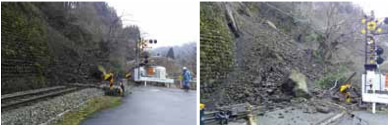
写真4 小谷村千国 JR大糸線の土砂崩壊 (撮影：岐阜大学 能島暢呂教授) →図1④
