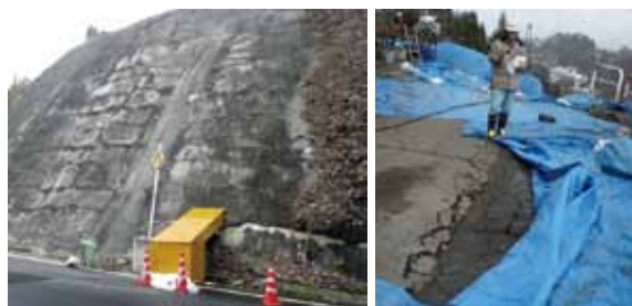
写真13 長野市広瀬 地すべりと道路の亀裂→図1⑬
