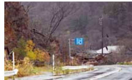
写真5 白馬村立の間 国道148号の斜面崩壊 →図1⑤
