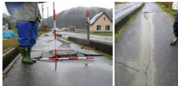
写真9 白馬村堀之内 液状化によるマンホールの浮き上がり と噴砂の跡→図1⑨
