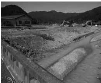
図5 徳尾川の復旧状況(10月24日)
