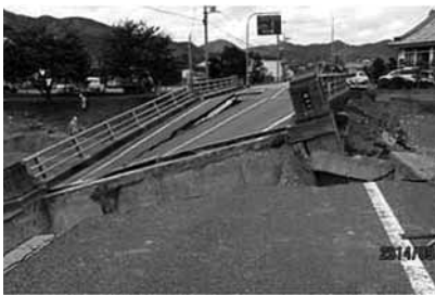
図8 八日市橋の落橋状況(8月21日)
