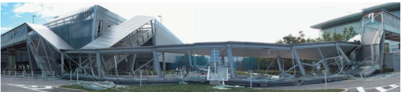
写真1 朱鷺メッセ歩道橋の落橋
