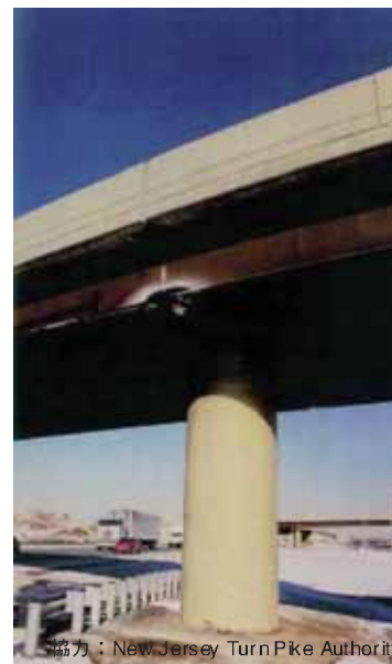
漏水部での限定的な不具合事例
