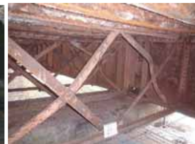
対傾構座屈状況
