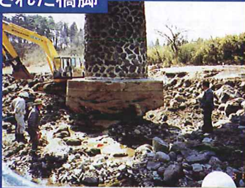
洗掘された橋脚
