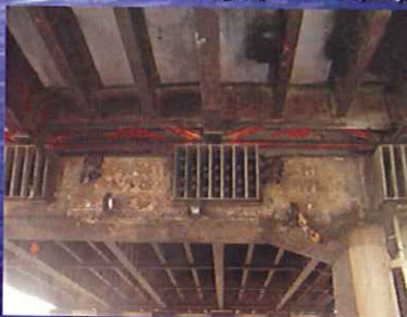
火災により損傷した構造物
