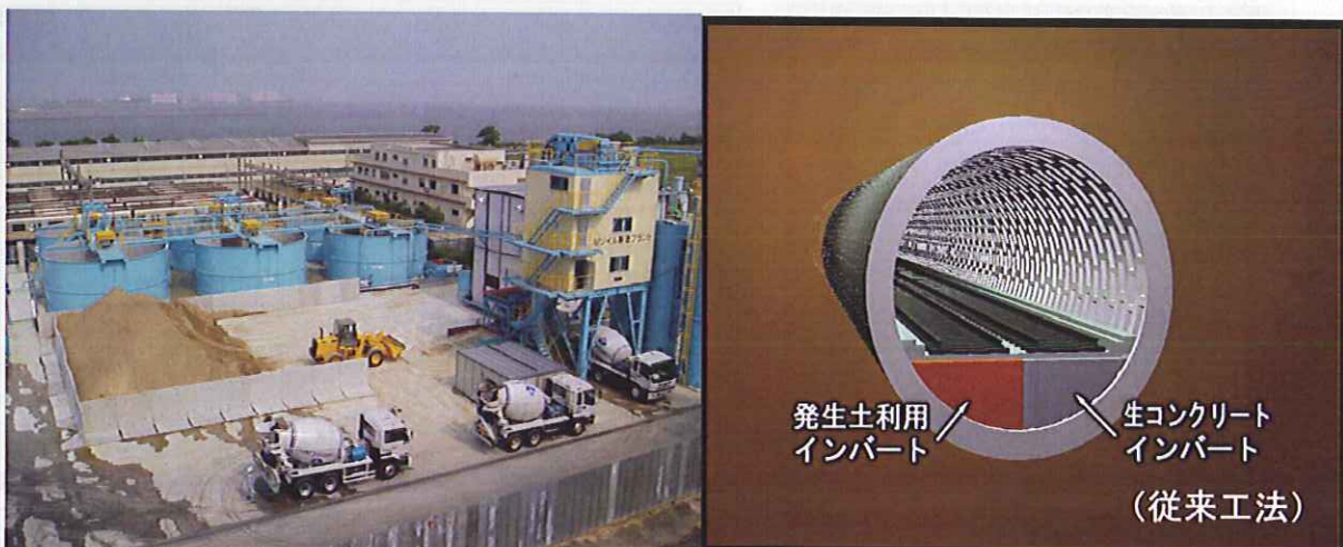
専用プラント(新木場車両基地内)
