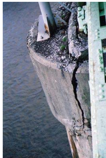
支承アンカーボルトによる 橋座の押し抜きせん断破壊
