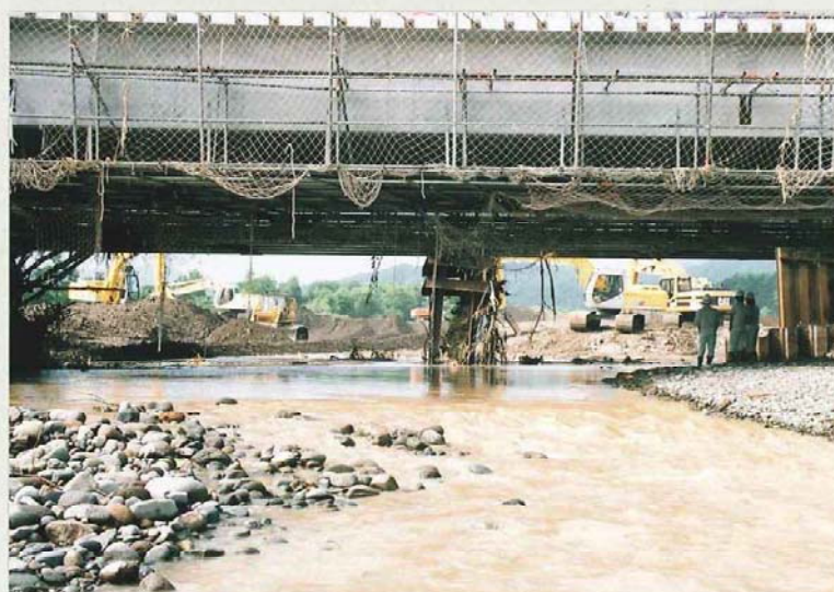
野田追橋【仮橋】のP3橋脚(被災) (手前: 架設中の新橋【下流】、左: 八雲町側、右: 森町側)
