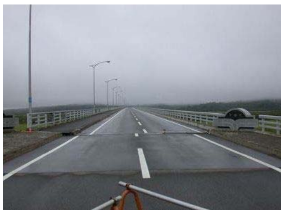
支承の破壊による横ずれ
