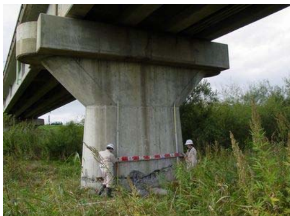
橋脚の曲げ破壊
