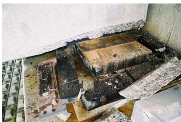
破壊された支承
