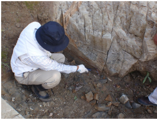
すべり面となったシルト層
