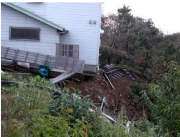
写真3.1-7 民家被災状況 (長岡技術大学提供)
