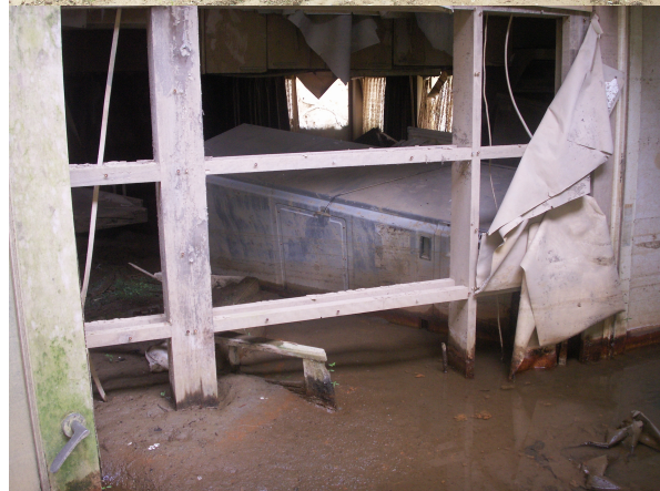
写真3.5-2 被災2年以上経過後も河道閉塞により放置された被災家屋と屋内の電気製品の状態 (旧山古志村：07.6.7)
