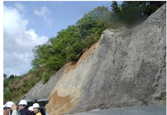
写真 3.1-12 吹き付け工の崩壊状況 1 (H17.5.13)
