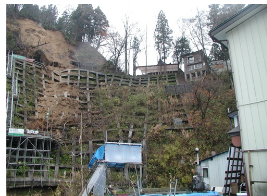
写真 3.1-16 吹付けのり枠工が施工されていない箇所の崩壊状況 (H16. 11. 28)
