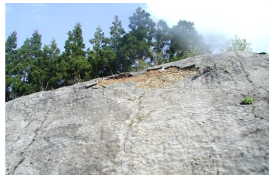
写真 3.1-13 吹き付け工の崩壊状況 2 (H17.5.13)
