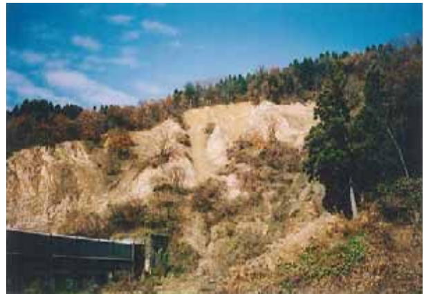
図 3.4-9 崩壊状況 (H17 重点研究報告書、2004.11.26)
