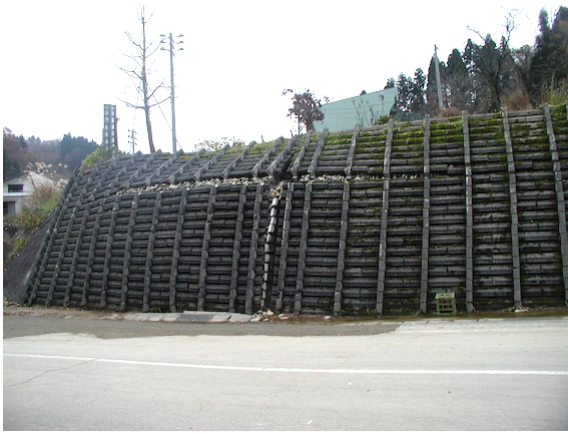
写真 3.1-9 亀裂が生じた井桁擁壁 (南荷項地区 H16.11.26)
