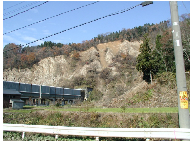
写真 2-9 上越新幹線妙見トンネル坑口の表層崩壊 (H16. 11. 26)
