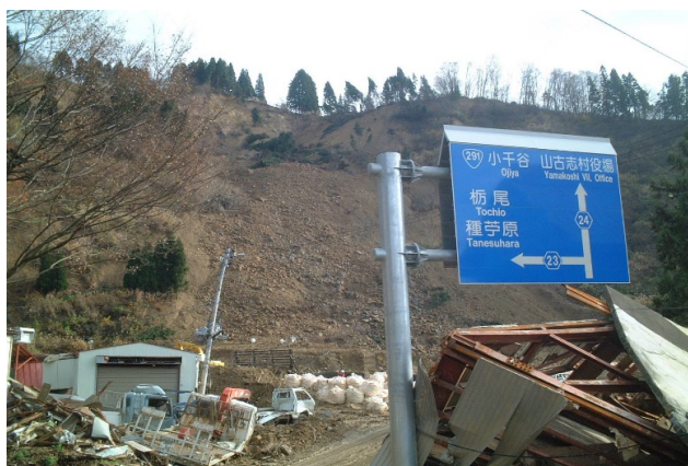
写真 3.2-24 崩壊状況 平成 16 年 10 月 遠景
