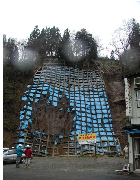
写真 3.1-14 吹付けのり枠工の崩壊状況 (H16. 11. 28)
