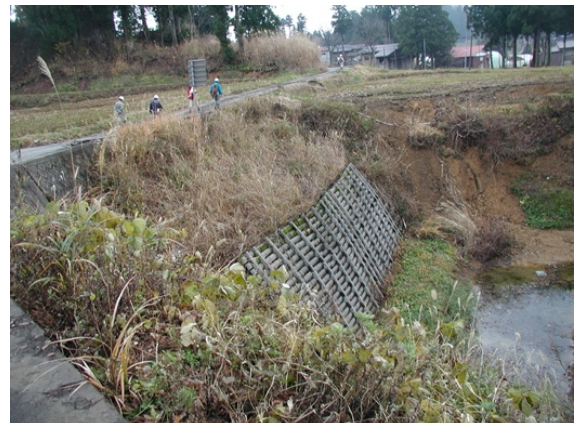
写真 3.1-11 孕み出しの大きい井桁擁壁 (塩谷地区 H16.11.28)
