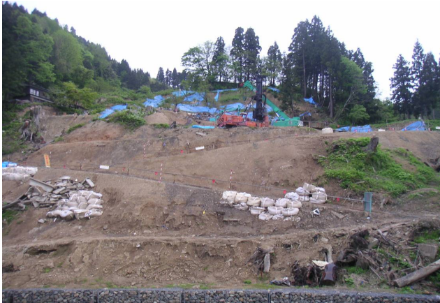
写真 3.2-37 崩壊状況 平成 16 年 10 月 遠景
