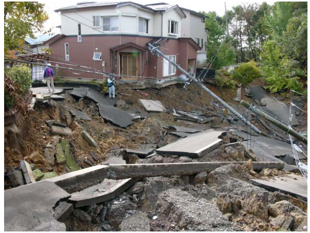
写真 2-8 高町団地の盛土崩壊 2)
