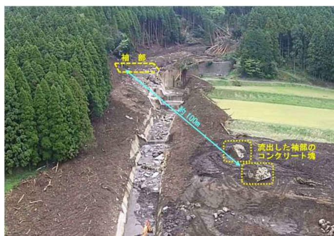
写真3.1-20 山王谷川砂防堰堤袖部の流出状況 (4/24撮影)
