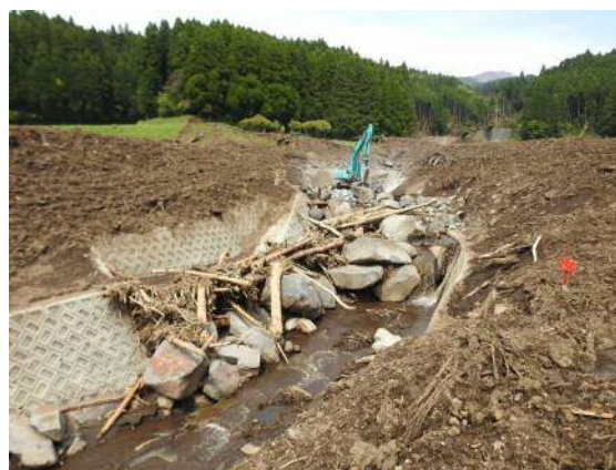
(下流流路工内の巨石堆積状況；5/8撮影)
