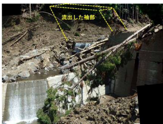
(山王谷川砂防堰堤の被災状況)
