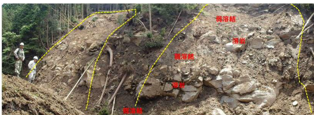
写真 3.1-21 崩壊地斜面内に認められる地質構造
