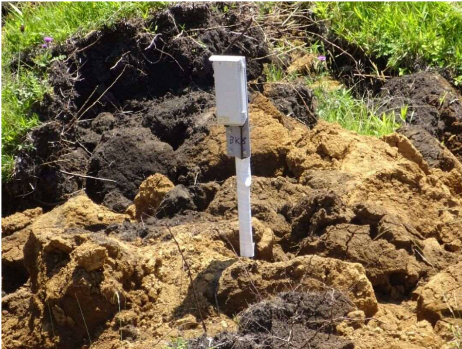
写真 3.1-7 崩壊箇所によく設置された表層傾斜計（MEMS 型）
