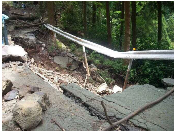
写真 3.1-32 道路法肩の小崩壊（盛土部であった可能性有）
