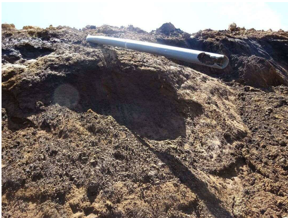
写真 3.1-5 崩壊土砂の中にあつた塩ビ管
