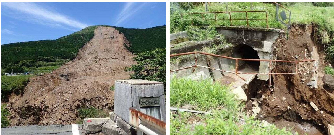
図 3.1-9 左：阿蘇大橋の落橋箇所，右：導水路の破損・漏水箇所
