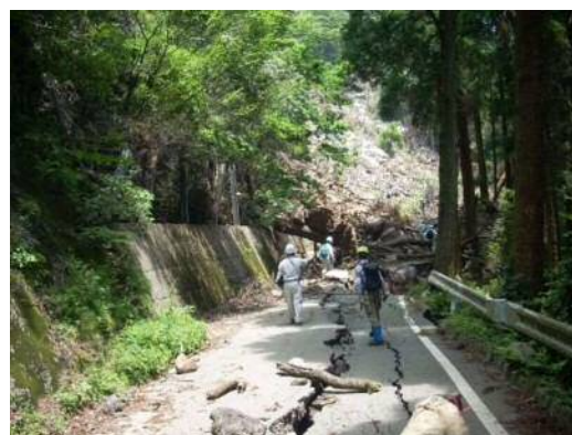
写真 3.1-31 舗装道路の破損
