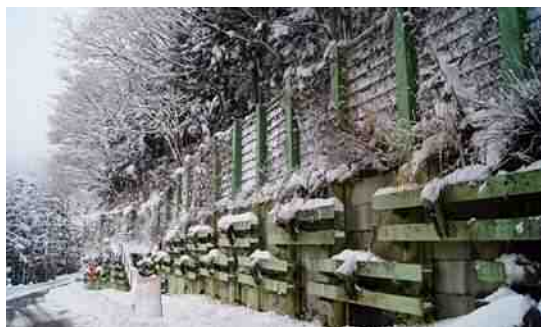
写真-4.2.2.1.5 小谷村中通地先アンカー変状
