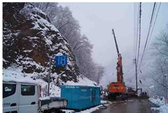
写真-4.2.2.1.1 国道148号白馬村立の間の崩壊箇所
