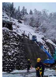
写真-4.2.2.1.2 JR大系線白馬大池・千国間の崩壊箇所
