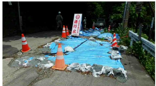
写真-4.2.1.2.1 道路進行方向に延びる崩壊
