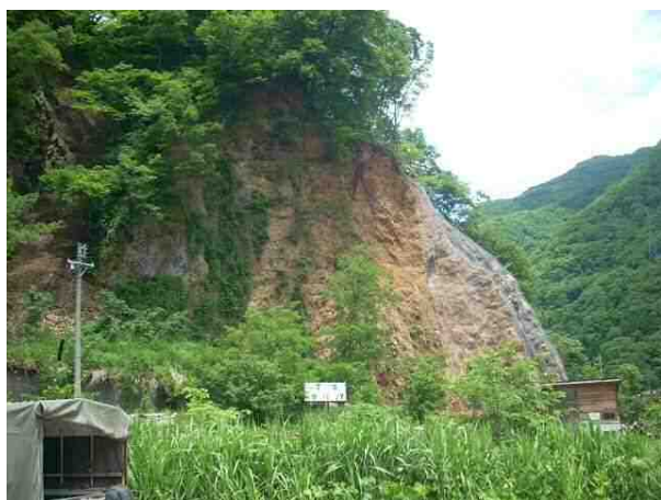
写真-4.2.1.3.1 通地区の斜面崩壊全景（A地点）
