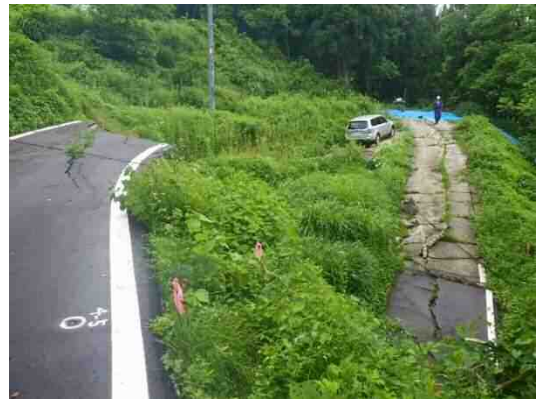
写真-4.2.1.6.4 西ブロック1の側方崖
