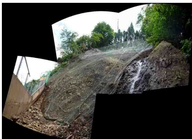
写真 4.2.1.4.3 崩壊面の状況
