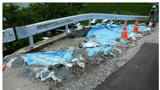
写真-4.2.1.2.2 道路沈下概況
