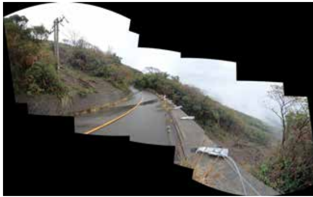
図 3.1.4.7 崩壊斜面下方の道路 (H26.11.1 撮影、土砂撤去後)
