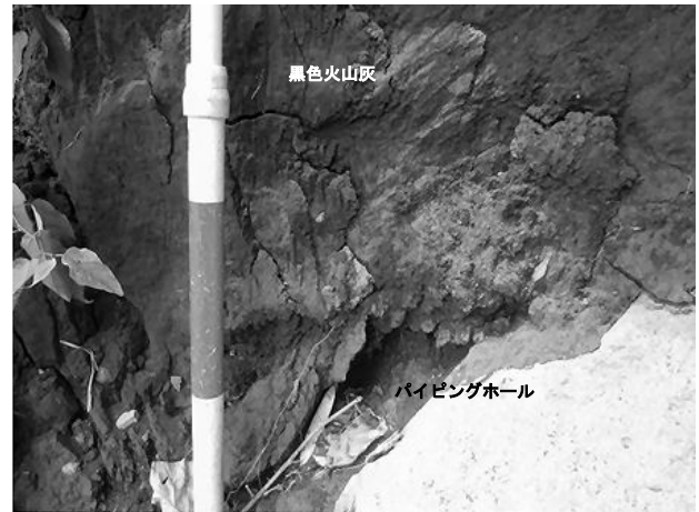
写真 1.4.5.2 表層崩壊の黒色火山灰とパイピングホール
