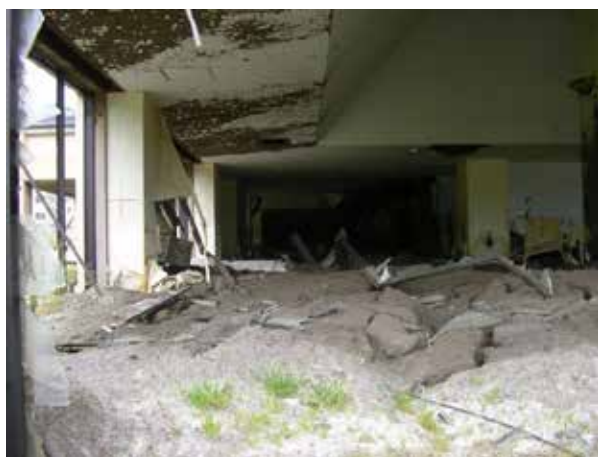
写真 2.1.1 2000 年有珠山噴火による泥流で埋まった建物
