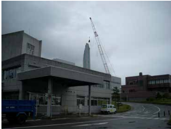
写真 2.3.4 中越沖地震における焼却施設の煙突の破損状況（2007 年 9 月 8 日現在）
