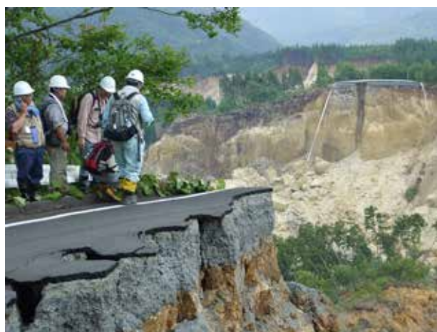
写真 2.1.2 2013 年岩手・宮城内陸地震時の荒砥沢地すべり
