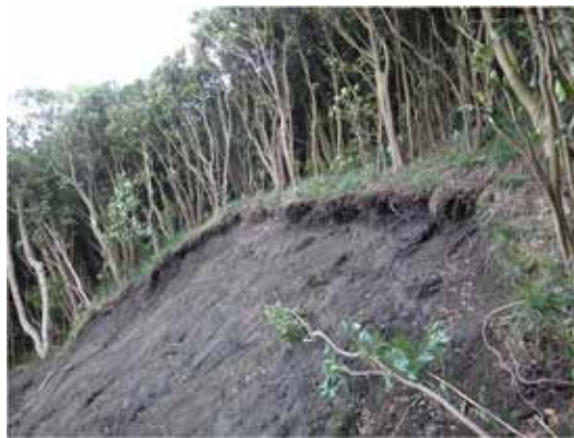
図 3.1.4.2 遷急線付近から崩落した表層崩壊地
