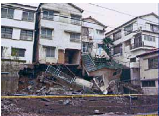
住宅崩落直後の状況
