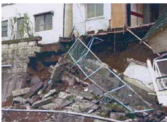
擁壁と大谷石の練積みの崩壊
