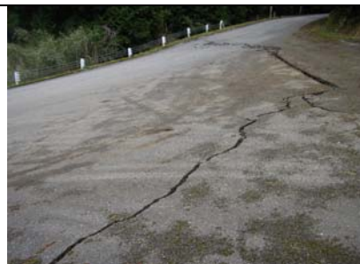
写真 5.4.2 震源近くの輪島市門前町広岡地区の地すべり内の道路盛土クラック。
