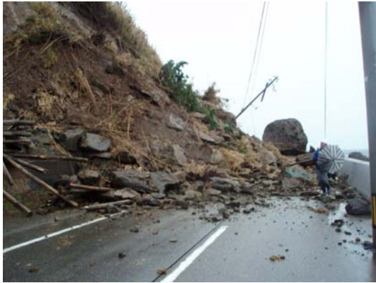
写真 5.1.4 表層崩壊と落石(S-14 地点)
