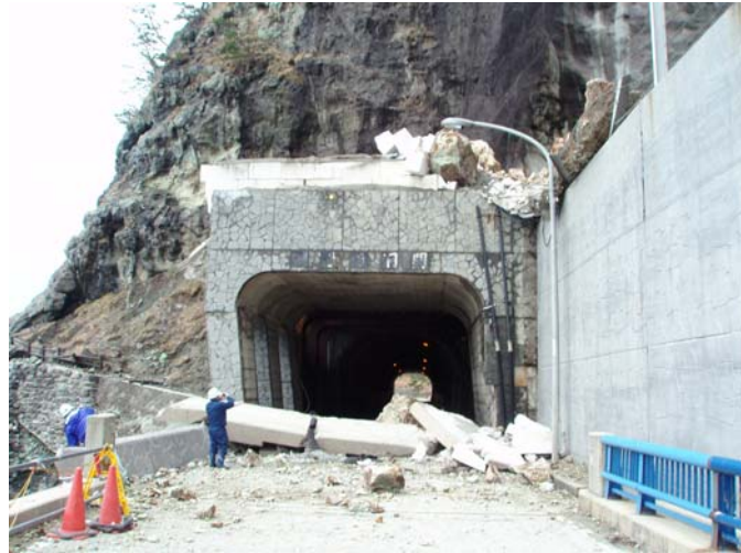
写真 5.1.9 崩落岩塊の一部による洞門の被災状況
