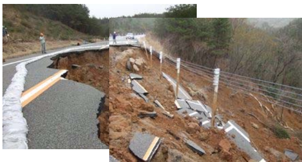
写真 5-2-16 14.7 km ポスト付近の崩壊（縦-21）
