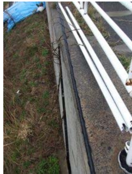
写真 5-2-1 道路腹付け盛土部の崩壊 (S-8)
