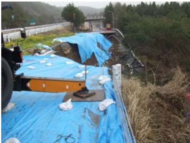
写真 5-2-11 横田 IC 付近の崩壊（縦-10）
