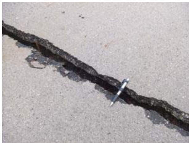
写真 5-2-22 着目した盛土の山側の亀裂
