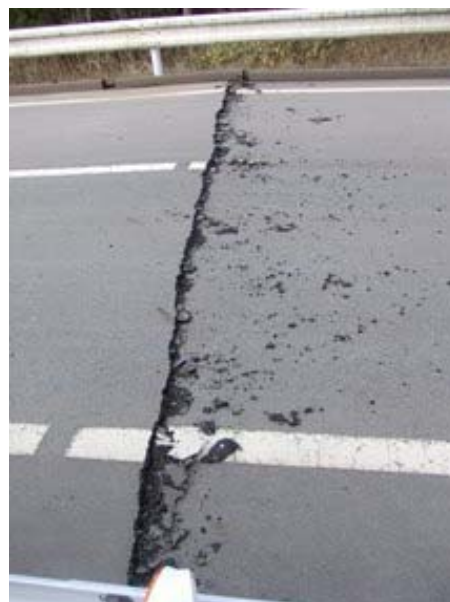
写真 5-2-23 着目した盛土の谷側の亀裂
