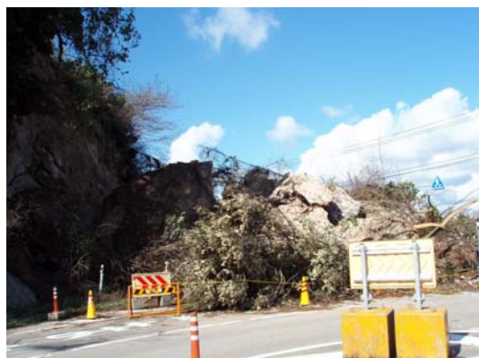
写真 5.1.2 横から見た尾根状部の転倒崩壊
