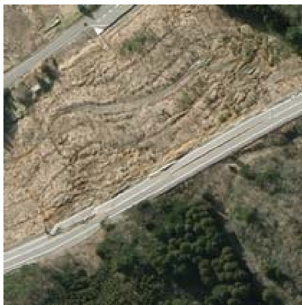
写真 5-2-8 道路決壊箇所平面（縦-9） （中日本航空殿提供）
