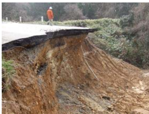
写真 5-2-19 11.7 km ポスト付近の崩壊（縦-14）
