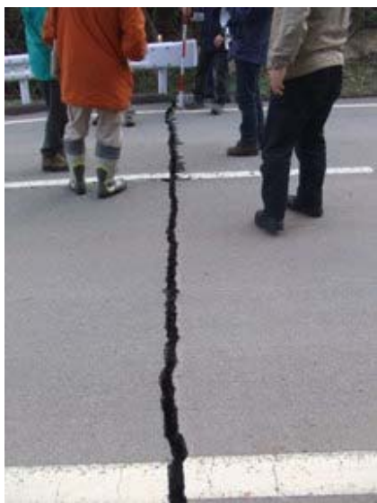
写真 5-2-21 着目した盛土の山側の亀裂
