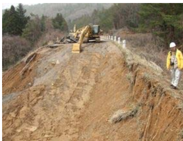
写真 5-2-18 11.7 km ポスト付近の崩壊（縦-14） 金沢方面
