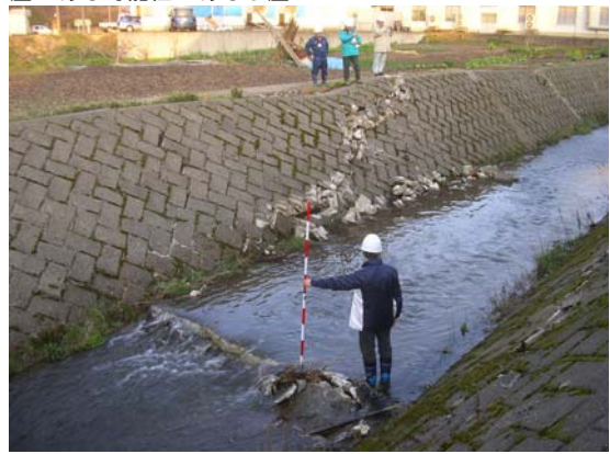
写真 4.4 小崖沿いの破損した流路工
