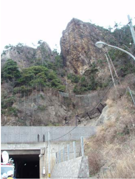
写真 5.1.8 洞門の右上の露岩部が崩壊発生位置
