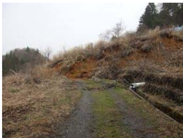
写真 5-2-10 崩壊土塊末端部の状況（縦-9）
