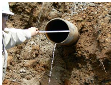
写真 5-2-13 崩壊面，排水管（縦-10）
