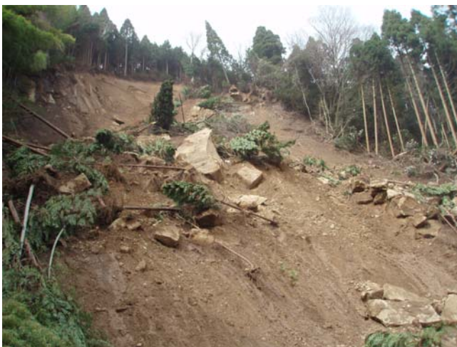
写真 5.1.10 山頂部、遷急線付近からの崩壊状況
