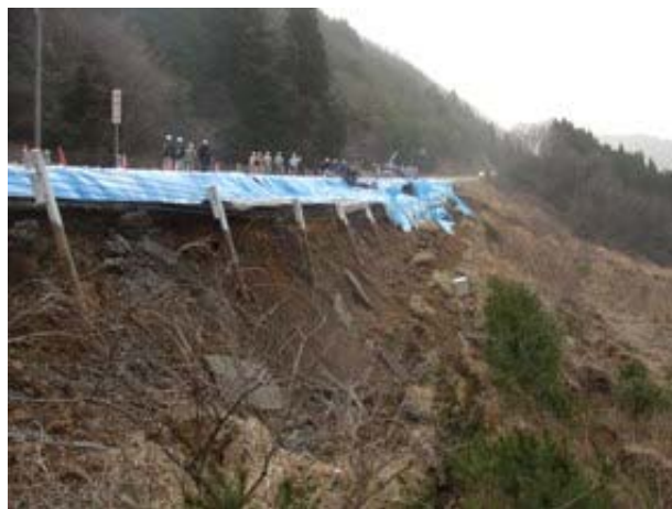
写真 5-2-9 崩壊頭部の状況（縦-9）
