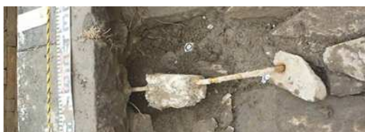
写真-3 石井閘門の笠石を支える金具 ・調査の結果ベルギー産の鉄でできていることが分かった。石巻とベルギーをつなぐ物語が生まれる。
