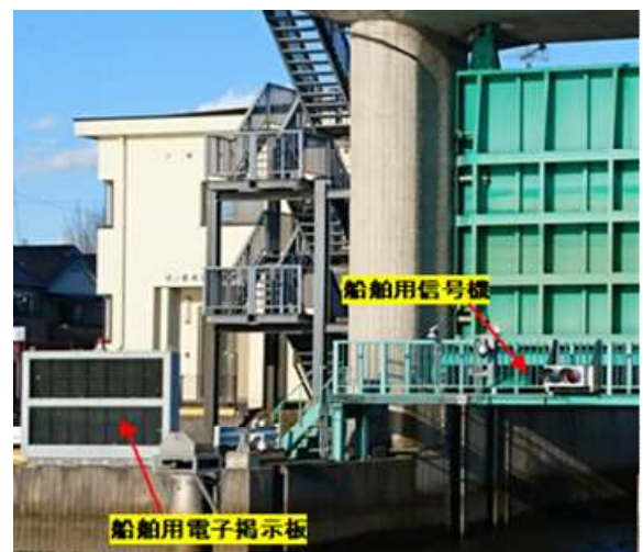
写真-2 中川と花畑川(運河)との合流部にある水門
