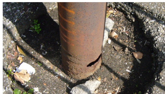
腐食が進み、鉄管に大きな穴が空いている
