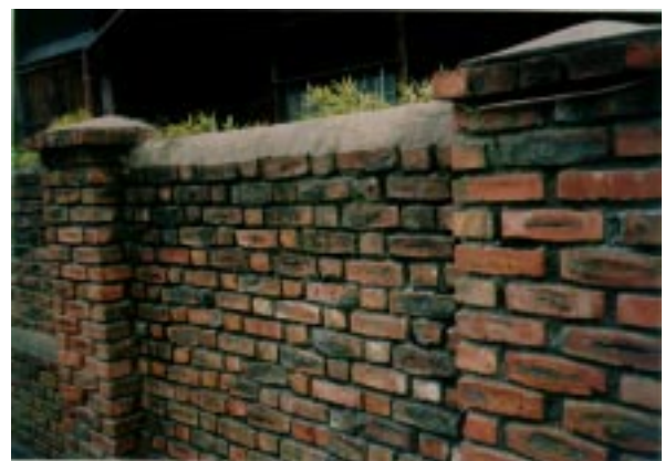
ヴォーリズ住宅の高温変形煉瓦塀（1997.10.10）
