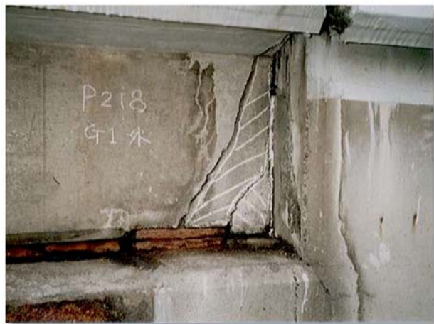
図－7 R C橋梁 損傷状況
