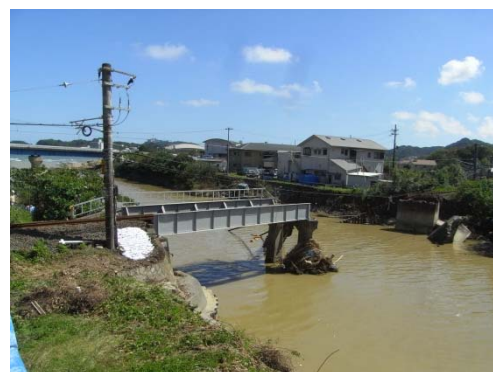
(a)被災状況
