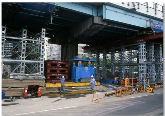
図－4 被災橋脚の撤去前状況
