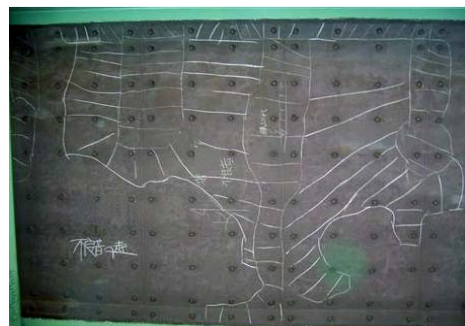
図-5 鋼板接着補強RC床版の鋼板の浮き
