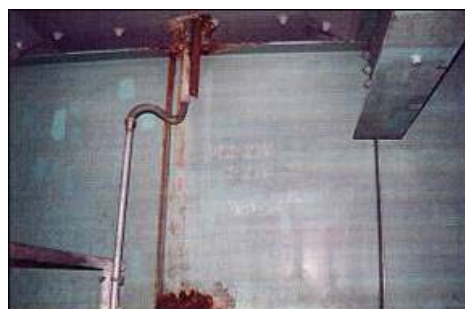
図-6 鋼板接着補強RC床版の漏水
