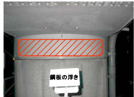
図-1 複合橋脚の接合部生じている浮き
