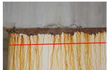
図-2 RC 脚鋼板巻立て上端部の腐食状況
