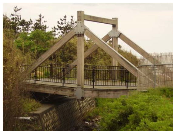
圖-2 旧橋損傷写真
