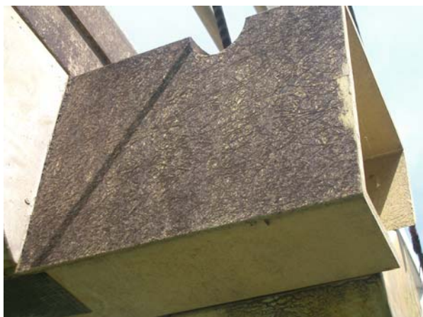
図－1 FRP の繊維露出の事例
