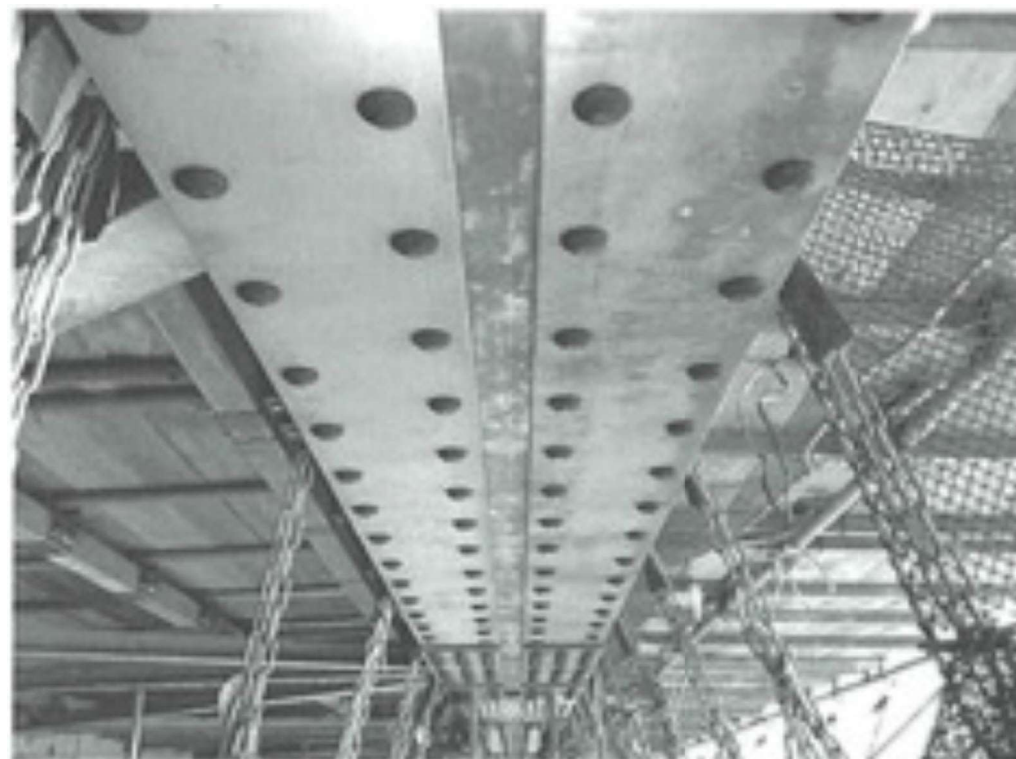
写真-3 下フランジ当て板補強
