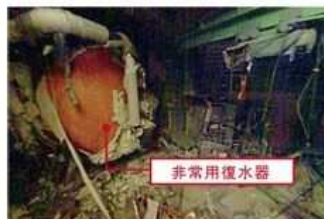
非常用復水器の被害状況
