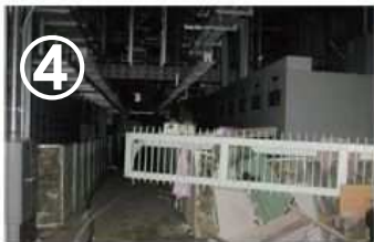
浸水した電源室の様子
