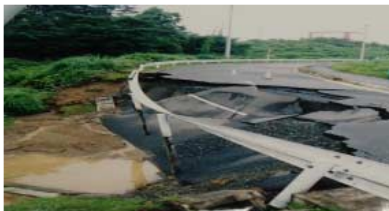
写真 - 2 路肩陥没と大塩配水池（右上） 日本水道協会東北地方支部宮城県本部提供
