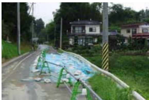
写真 - 4 鹿島台流入地点の道路陥没
