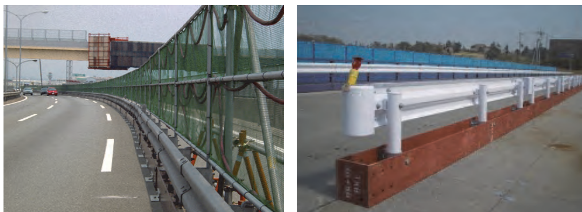
写真 2.1.1 一般的な仮設材による防護柵事例
