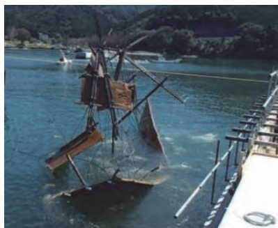
写真 3.4.1 波浪による型枠損壊事例
