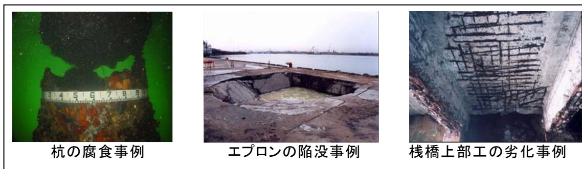
図 4-13 港湾施設の劣化、損傷の事例
