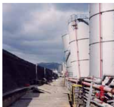
(d) 液状化により傾斜した貯槽
