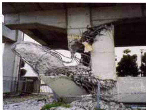
(b) 鉄道高架橋コンクリート柱のせん断破壊
