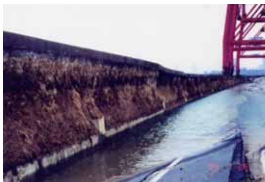
(c) 液状化による護岸の移動
