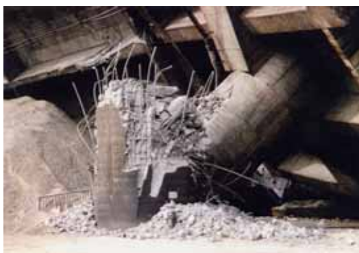
(a) 道路鉄筋コンクリート橋脚のせん断破壊
