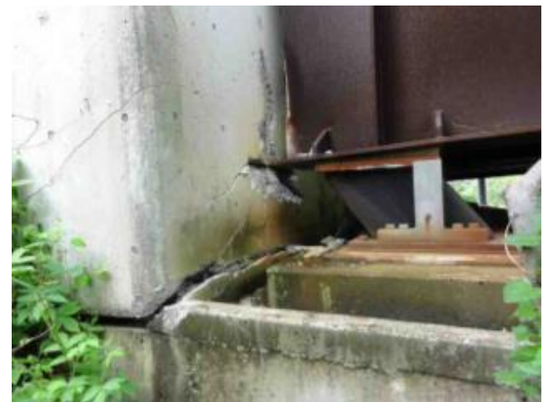
主桁と橋台の衝突
