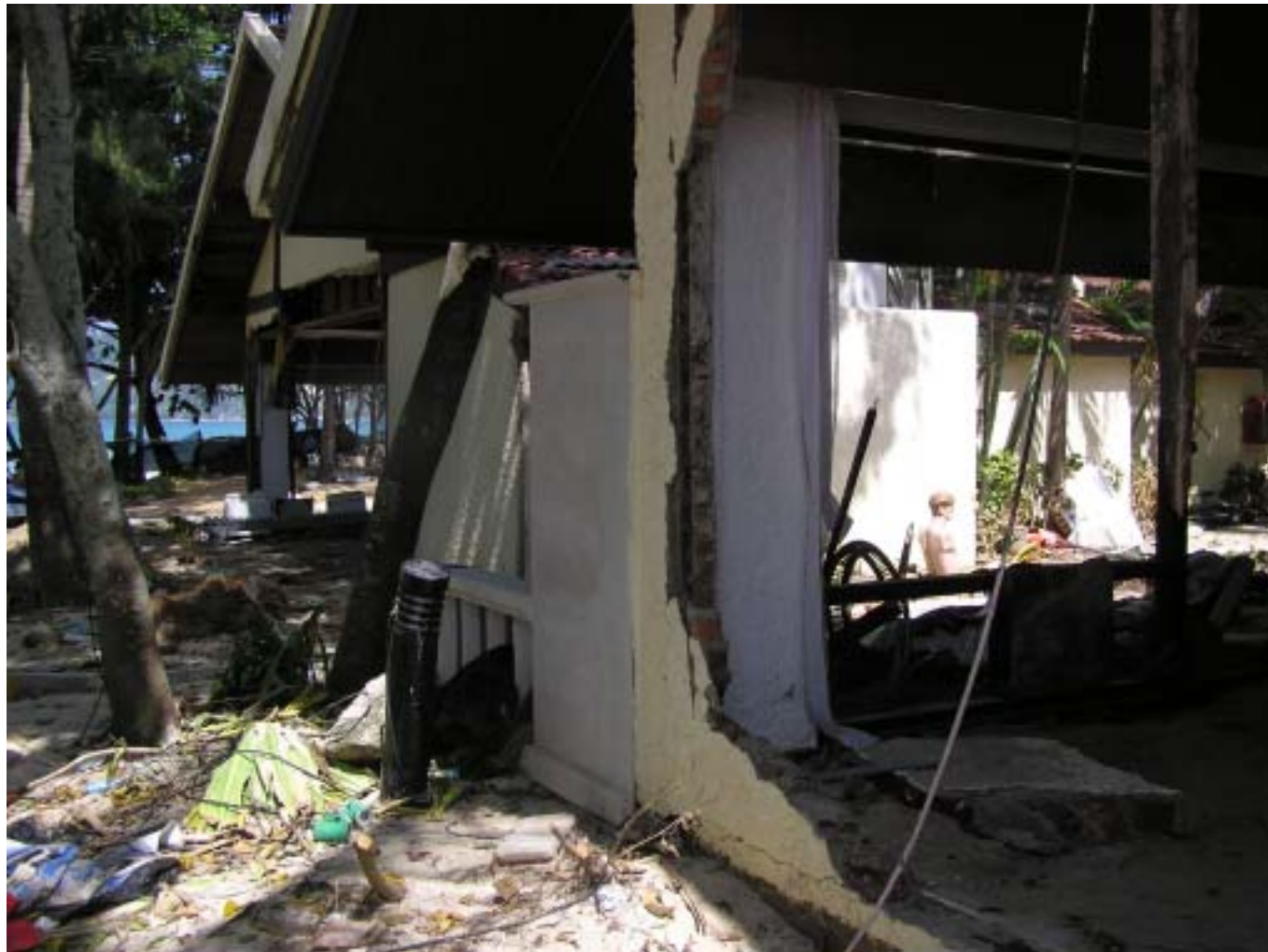
壁が壊された煉瓦造の家屋 (Patongビーチ)
