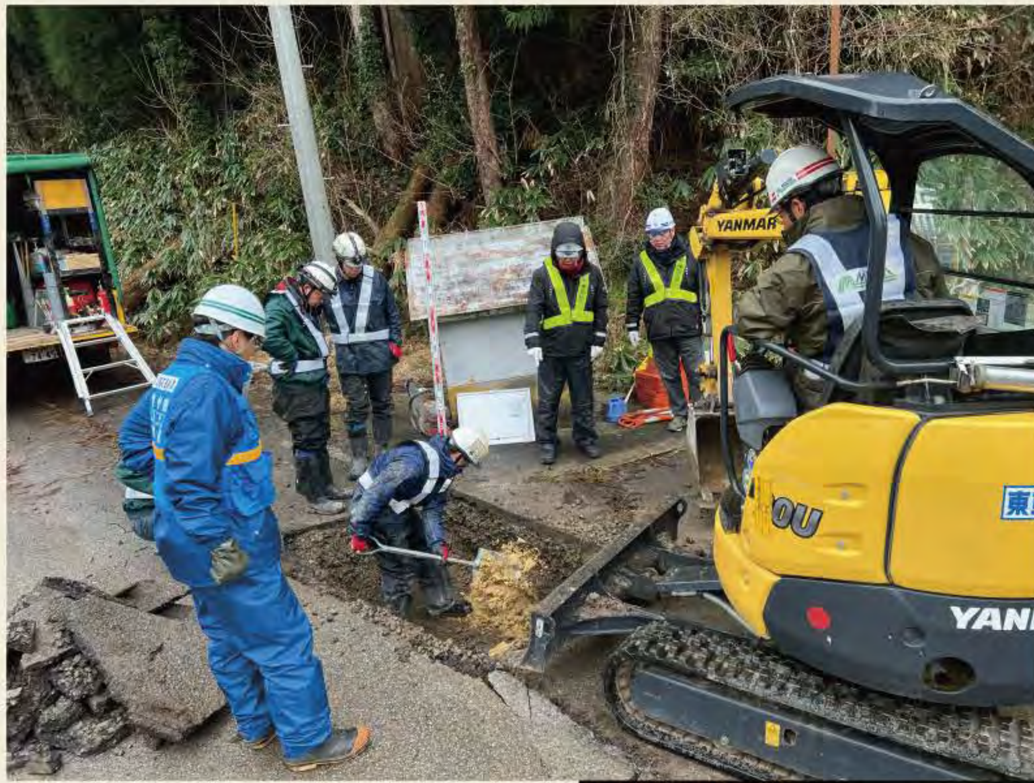
宮城県管工業協同組合による漏水修繕工事（飯田地区）の様子 （令和6年2月25日）
