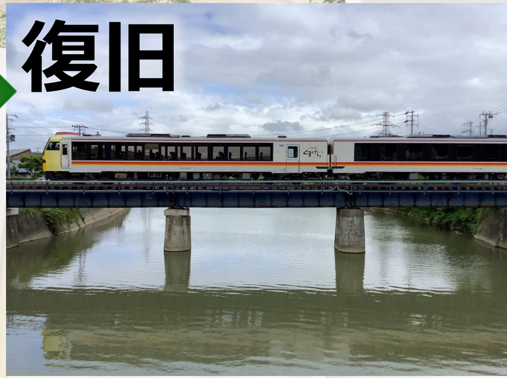
五能線 中村川橋りょう洗堀災害
