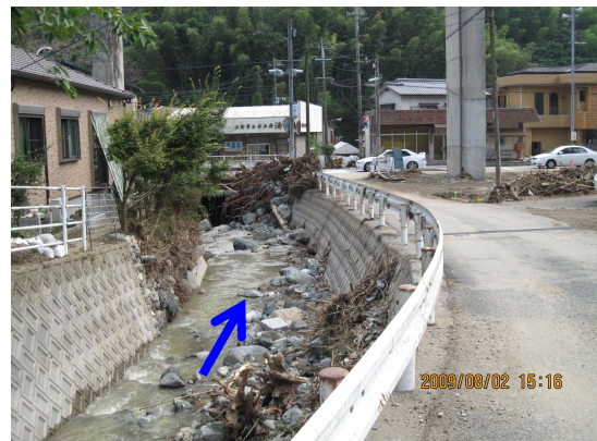
図-8 一の滝から(山手公民館前の)国道201号に向かう溪流沿いの町道(溪流は国道の下を通過して多々良川に合流)
