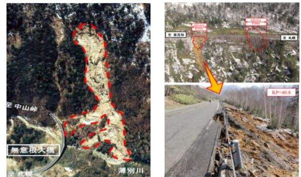
写真-1 国道 230 号中山峠の被災状況
