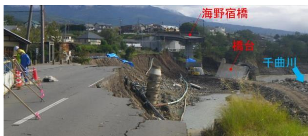
図-8 被災箇所状況 (2019.10.24 下流から撮影)
