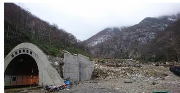
写真-2 被災地の様子（野塚トンネル 広尾町側 坑口付近：令和2年11月13日撮影）
