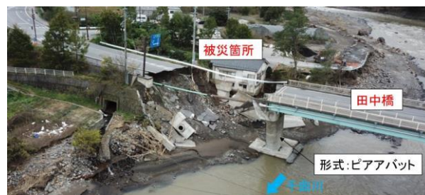
図-6 被災箇所の状況 (2019.10.24 下流から撮影)
