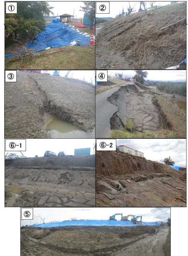
図-13 堤内側法面の洗堀 (2019.10.24 撮影)
