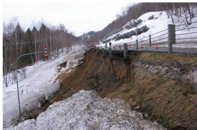
国道230号中山峠斜面崩壊(2013.4.7)
