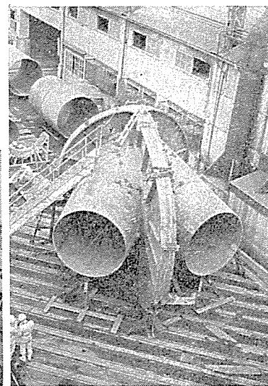
写真—5.5 東京電力下滝発電所 Y 分岐
