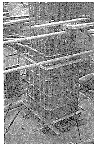
写真—5.40 柱コンクリートの鋼製型わく
