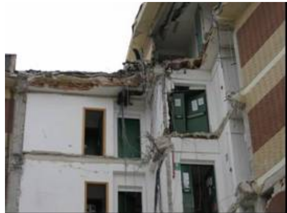
写真-70 増築部分の梁鉄筋が露出
