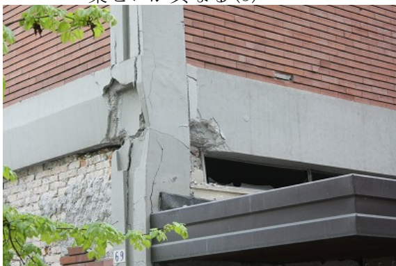
写真-51 1階ピロティ柱頭－接合部の損傷(8)
