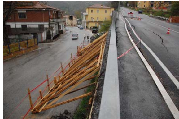
写真-159 沈下した路面
