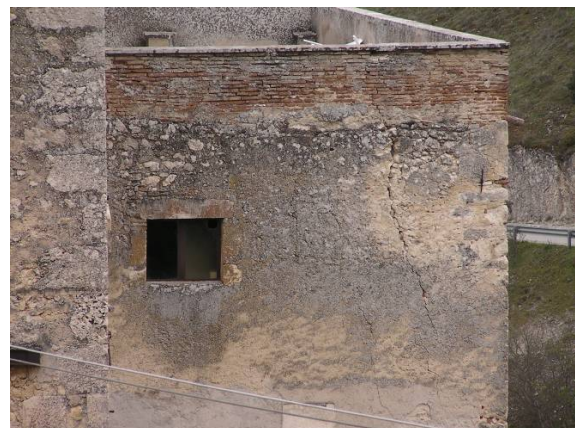
写真-126 バルコニーのひび割れ
