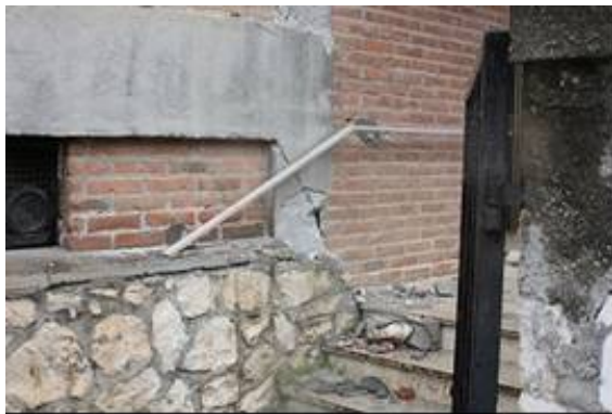
写真-102 柱脚部のせん断ひび割れ
