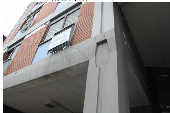
写真-52 2階床梁のせん断ひび割れ(8)
