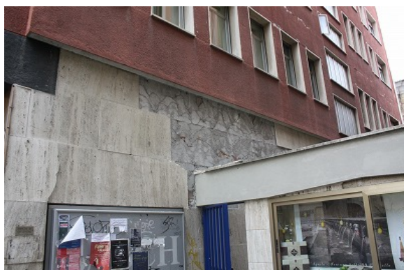
写真-37 鉄骨埋め込み部周辺の損傷(2)
