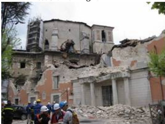
写真-35 組積造の 2 階部分が崩壊
