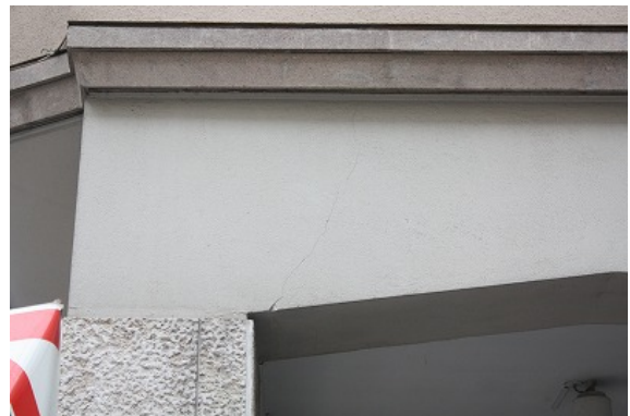
写真-44 梁のひび割れ(曲げひび割れ)(4)
