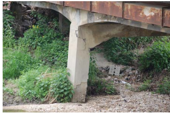
写真-142 RC ラーメン橋脚の損傷
