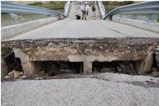
写真-131 3径間連続橋の落橋 (Fossa 駅近く)
