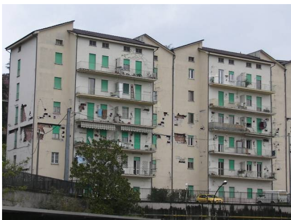
写真-67 3階、4階での被害が目立つ(5)
