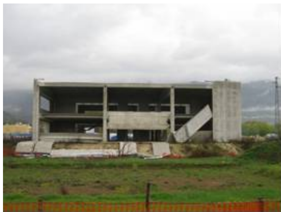
写真-85 建設中のPC造工場の被害
