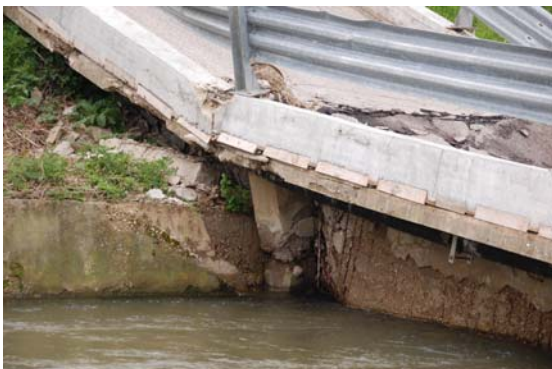
写真-133 パイルベント橋脚の損傷
