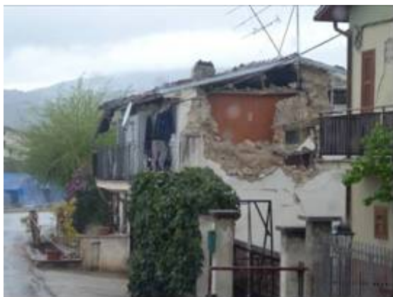
写真-93 石積+土目地壁の崩壊
