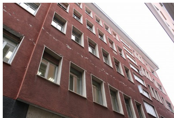
写真-38 壁のひび割れ（2,3階境界位置）(2)
