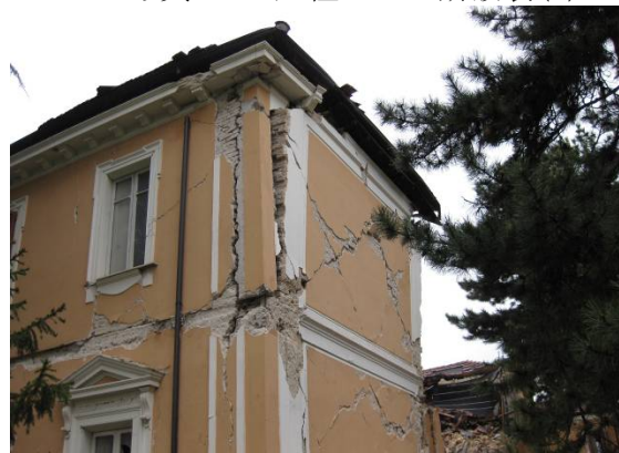
写真-62 壁が面外方向に傾斜(3)
