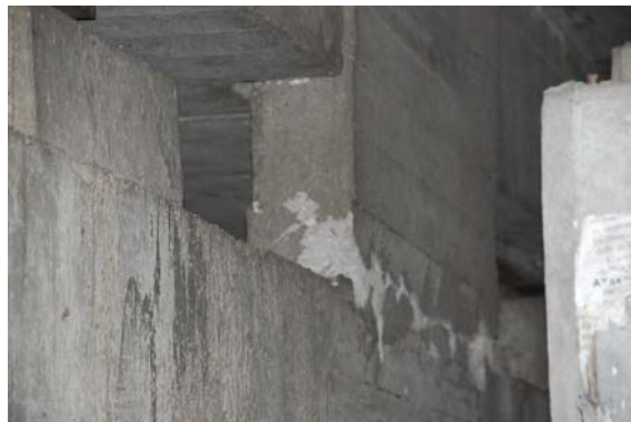
写真-157 せん断キーの損傷
