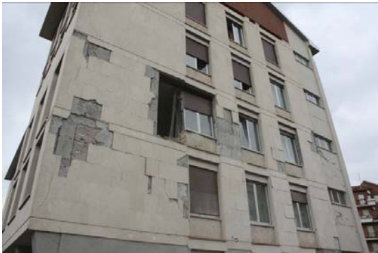
写真-59 仕上げ材の剥落(2)
