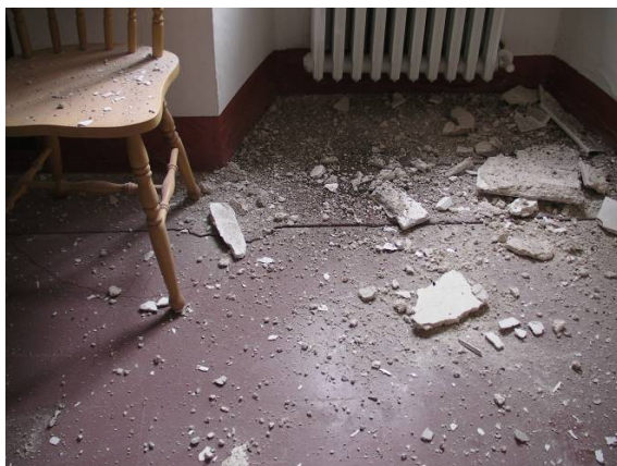
写真-125 床のひび割れ
