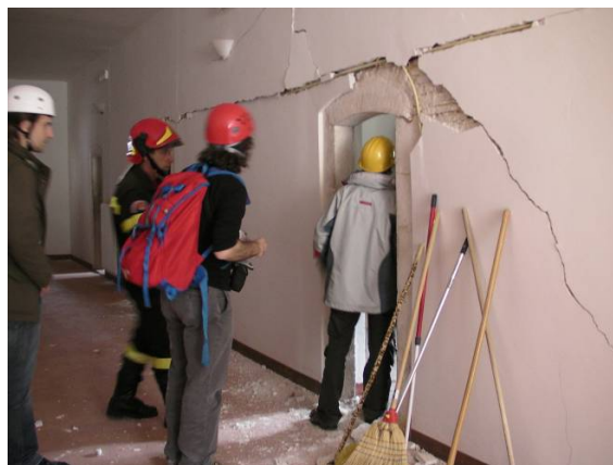
写真-124 壁のひび割れ
