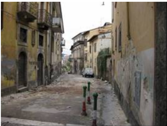
写真-29 Via Donadei 通りの仕上剥落
