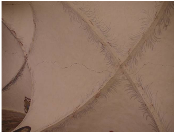
写真-127 ヴォールトのひび割れ
