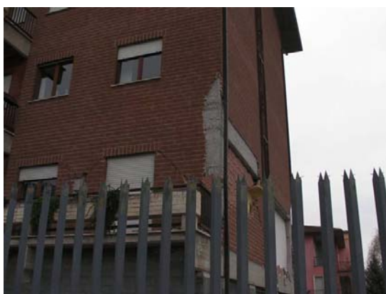
写真-119 開口部間のせん断ひび割れ
