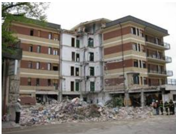
写真-69 学生寮の崩壊
