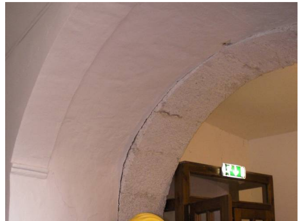
写真-128 アーチのずれ
