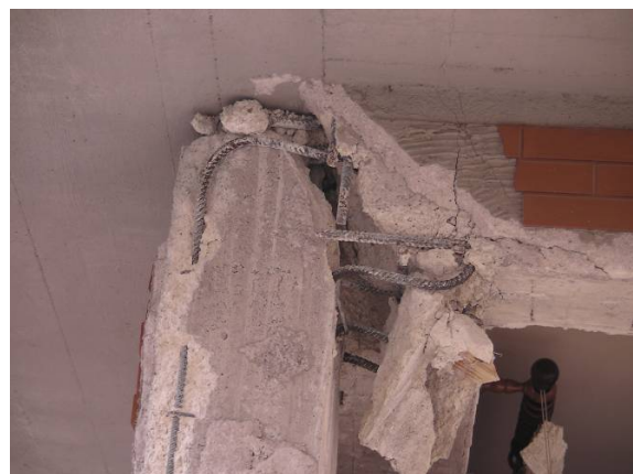
写真-112 柱梁接合部の破壊状況
