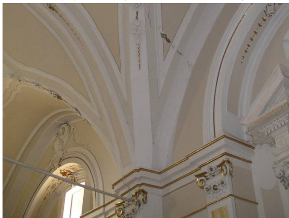
写真-129 ヴォールトのひび割れ
