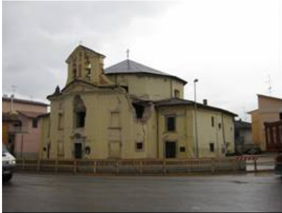
写真-89 教会の組積壁の崩落
