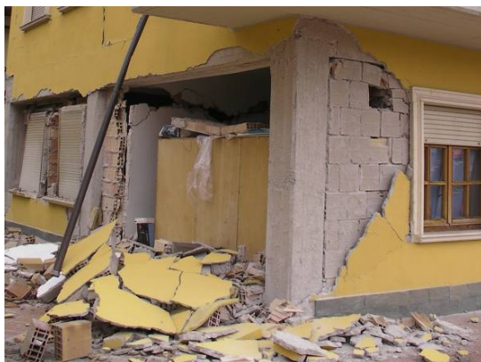
写真-117 煉瓦ブロック壁の面外崩壊
