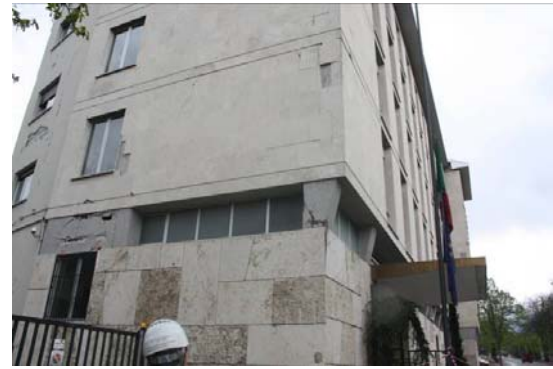
写真-60 短柱のせん断破壊(2)
