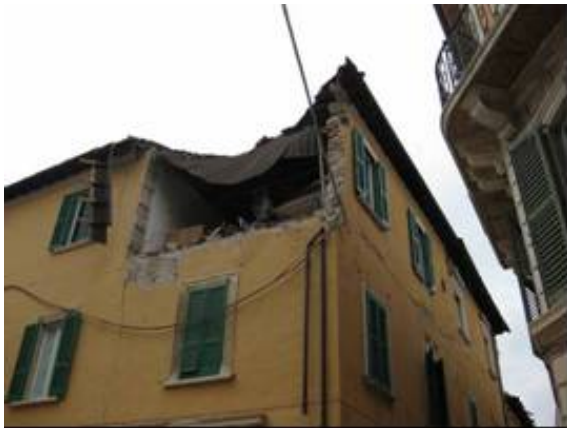
写真-31 組積造 3 階部分の外壁が崩落
