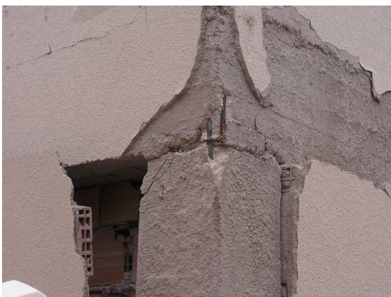
写真-111 柱頭の破壊状況
