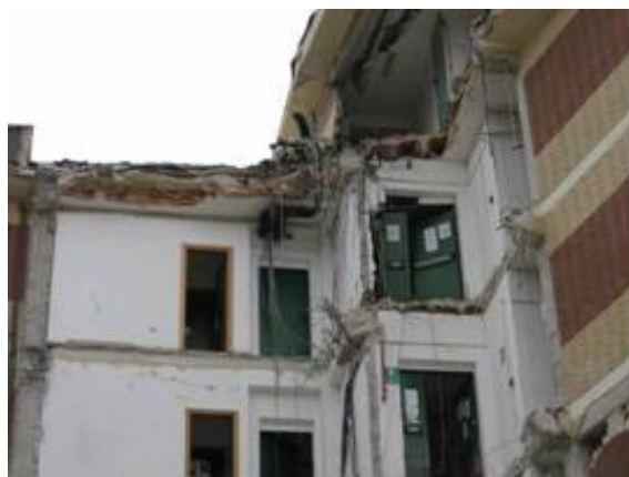
写真-70 増築部分の梁鉄筋が露出
