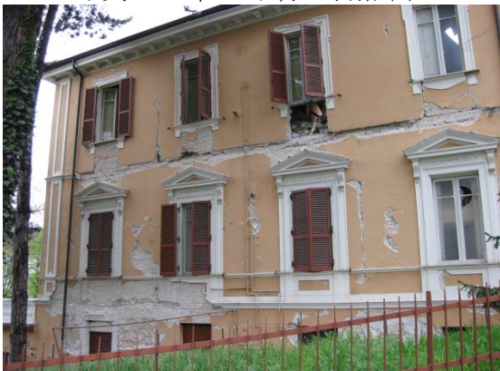
写真-61 長辺方向の損傷状況(3)
