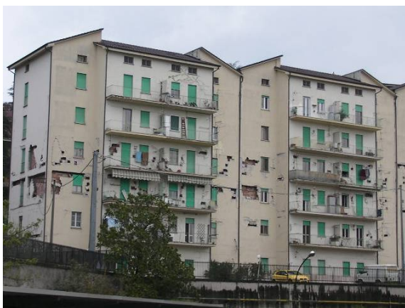
写真-67 3階、4階での被害が目立つ(5)
