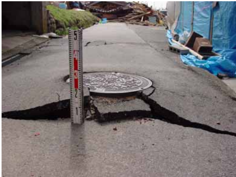
マンホール (門前町清水)
