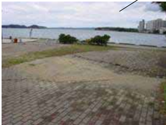
インターロッキング基礎地盤からの噴砂
