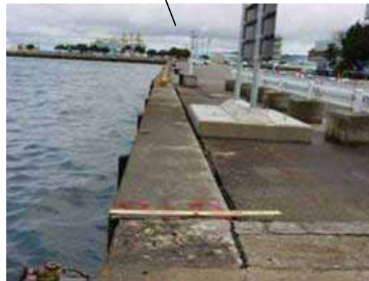
岸壁のはらみ出し
