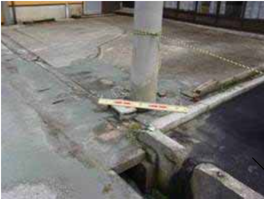
電柱基礎地盤からの噴砂
