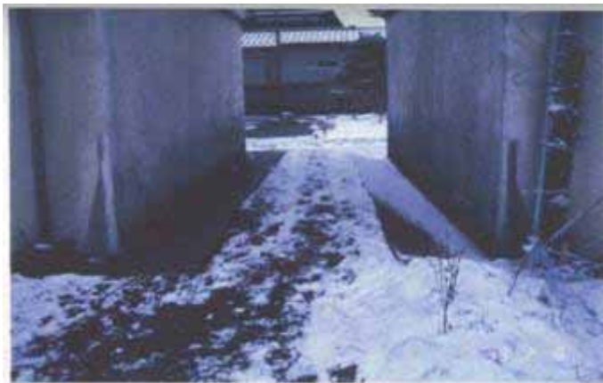
写真20 市営住宅の沈下（正院町正院）
