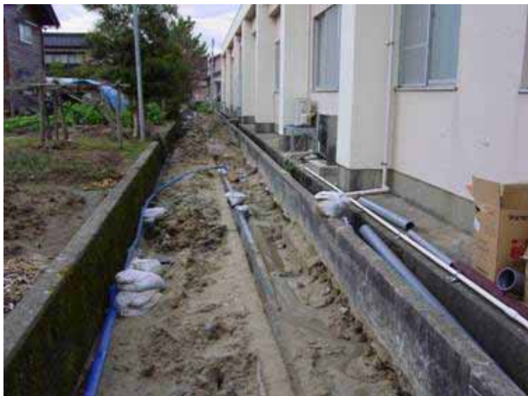
下水道管路 (七尾市田鶴浜)
