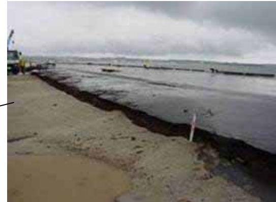
ケーソン岸壁背後のエプロン約30cm沈下
