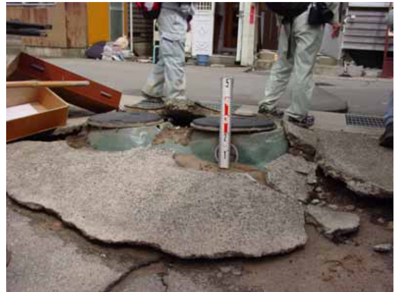
浄化槽 (門前町清水)
