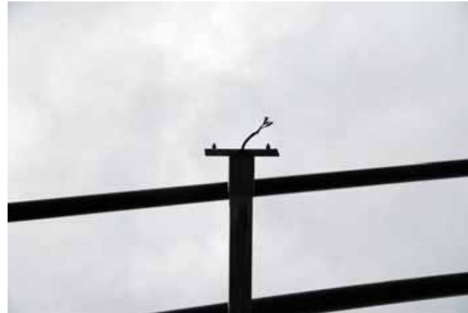
照明塔の照明が落下 (2ヶ所)
