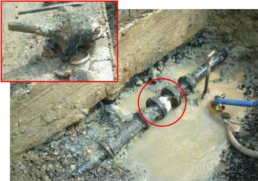
仕切弁本体部の破損
