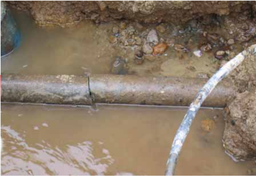
100 ACPの管体折損
